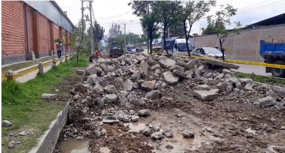
Figura 4: Rotura de tubería matriz superficial de alcantarillado en la obra de pavimentación urbana de la Av. del Deporte.
