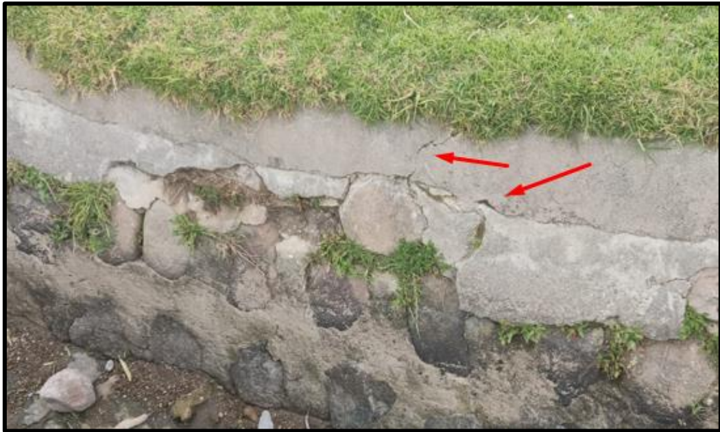
Figura N°3: Grieta en canal
