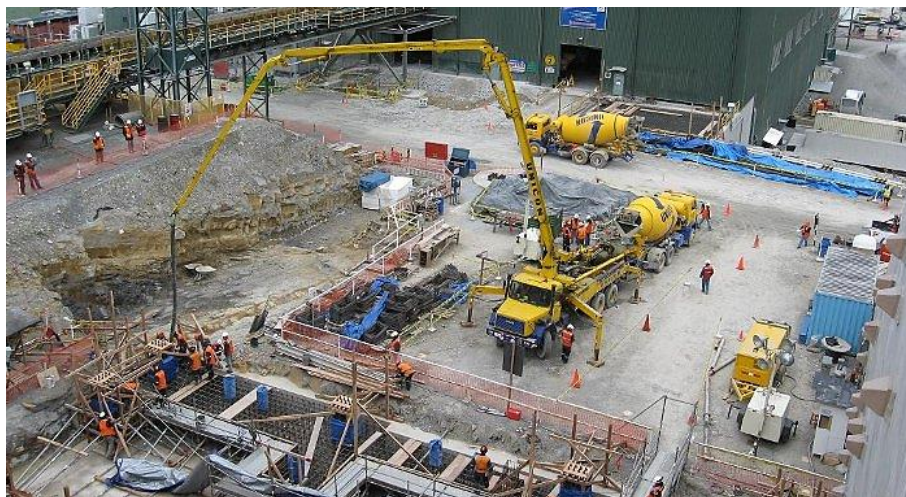
Figura 2.12: Detalle del proceso de colado utilizando el concreto pre-mezclado. Fuente: Empresa concretera UNICON. Lima - 2010.
