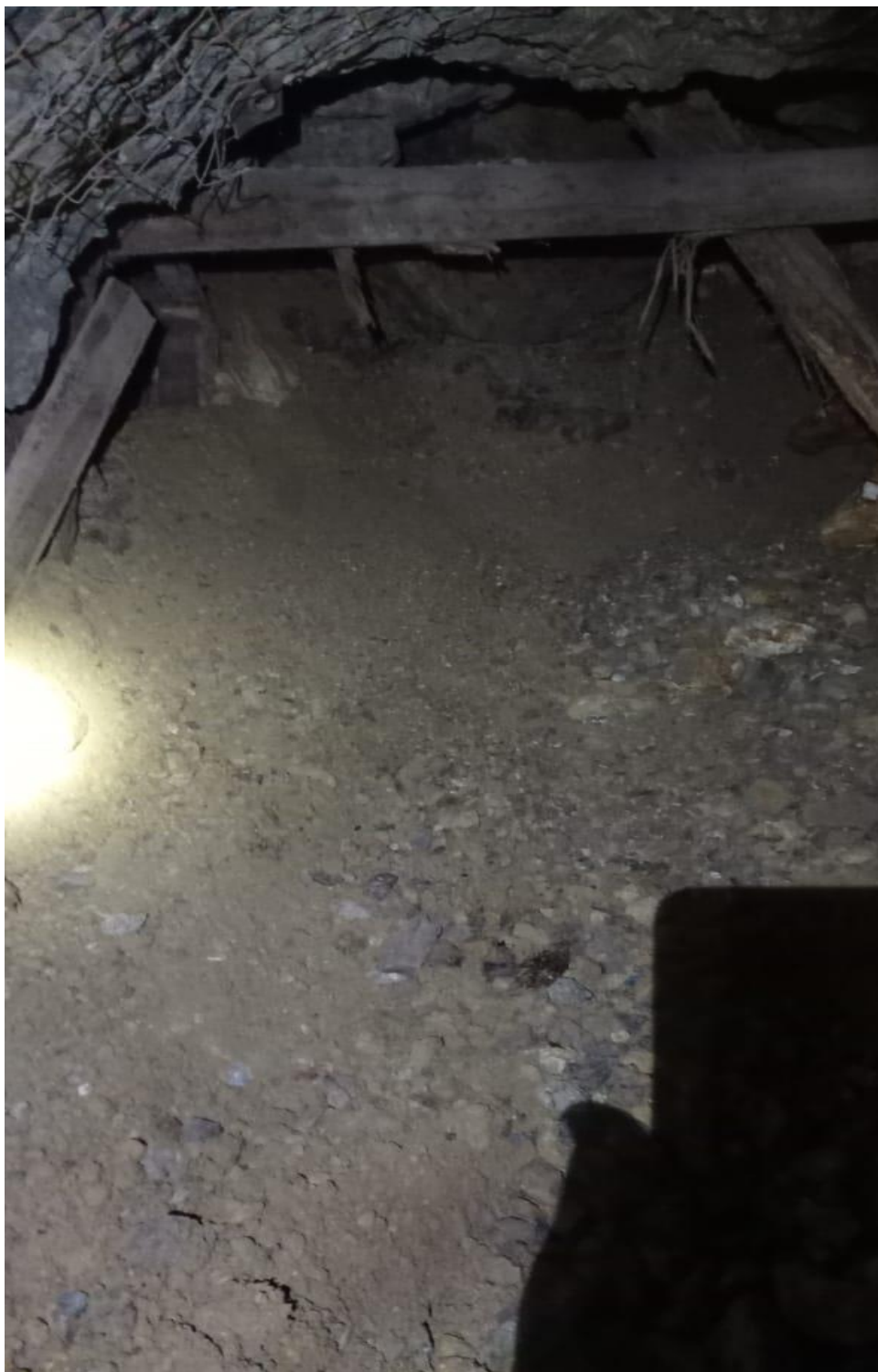
Foto 8: Resultado de una Voladura deficiente, sin control, teniendo como resultado una ventana con poca producción de mineral.
