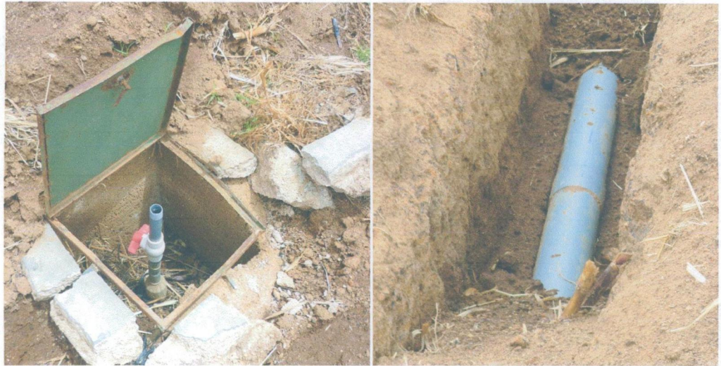
Fotografía N°03: Situación de algunos componentes del sistema de riego en la comunidad de Llutacancha al primer año de funcionamiento.
