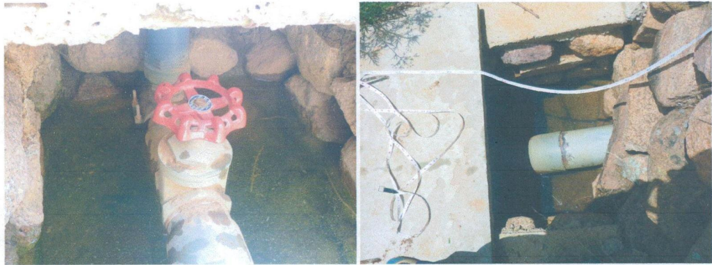
Fotografía N°02: Caja de válvula de control en el reservorio –cámara de carga.
