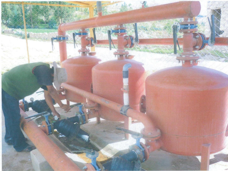
Fotografía N°08: Cabezal de riego y sistemas de filtrado del sistema de riego en la comunidad de Uchuypampa.
