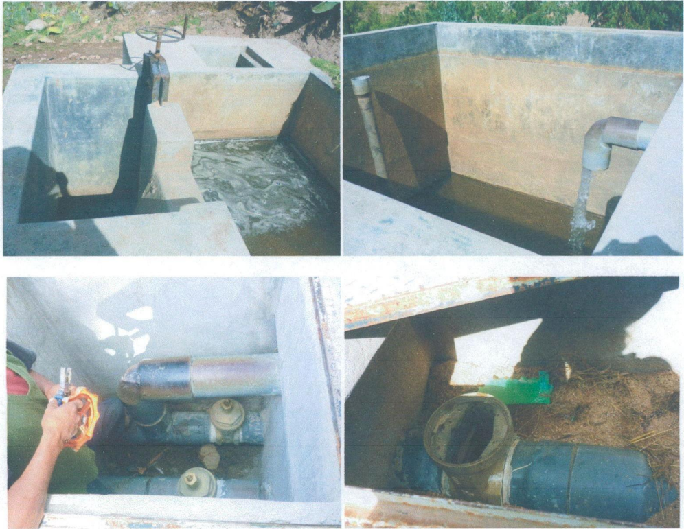
Fotografía N°07: Componentes del sistema de riego tecnificado en la comunidad de Uchuypampa al sexto año de funcionamiento.
