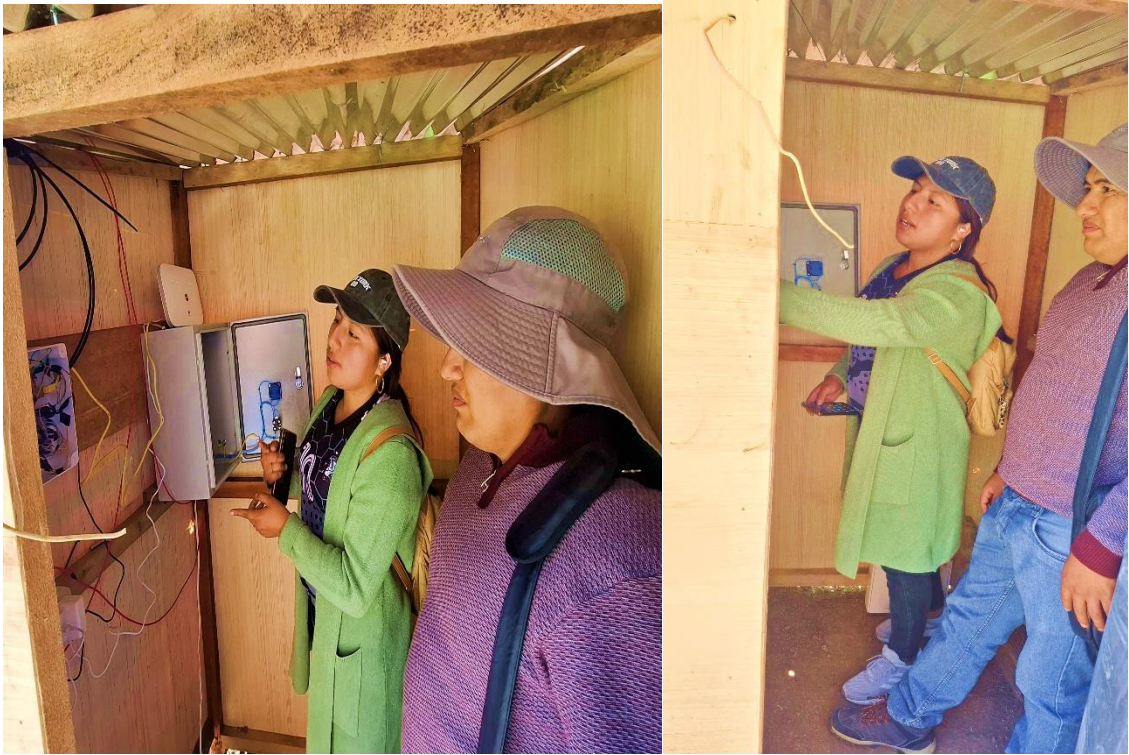
Figura 13 Inspección del Arduino y sistema eléctrico en la caseta de control
