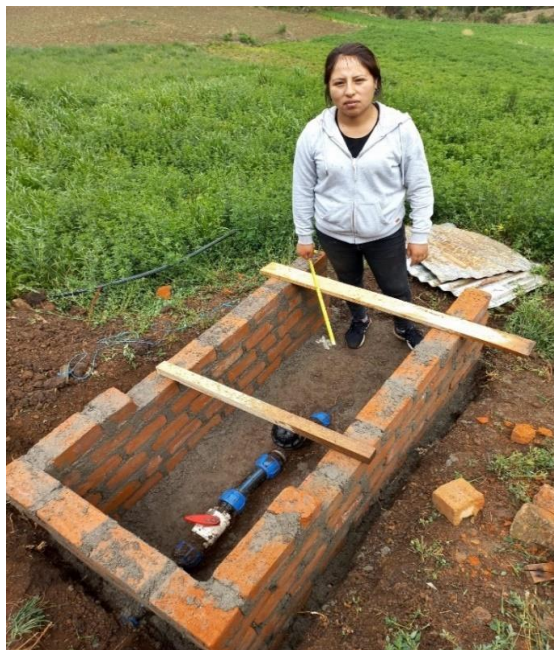
Figura 2. 27 Caja de protección en el cabezal de riego
