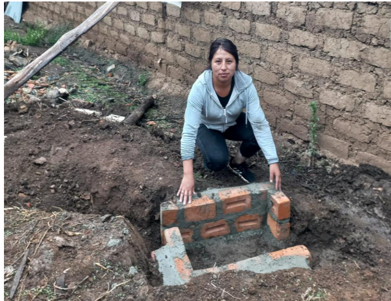
Figura 2. 28 Caja de protección para la electroválvula
