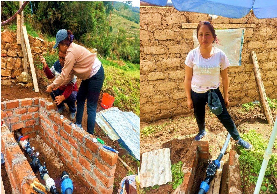
Figura 5 Implementación de los sensores y electroválvula al sistema de riego por goteo
