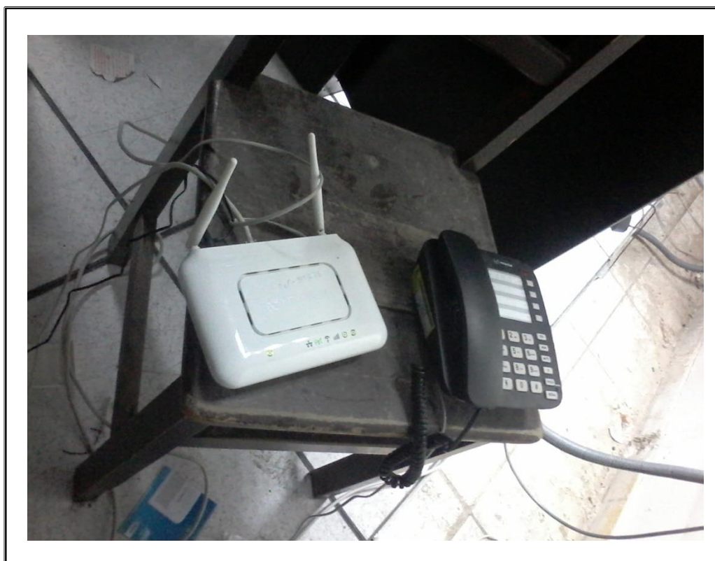
Figura C. 5. Router de la MPH
