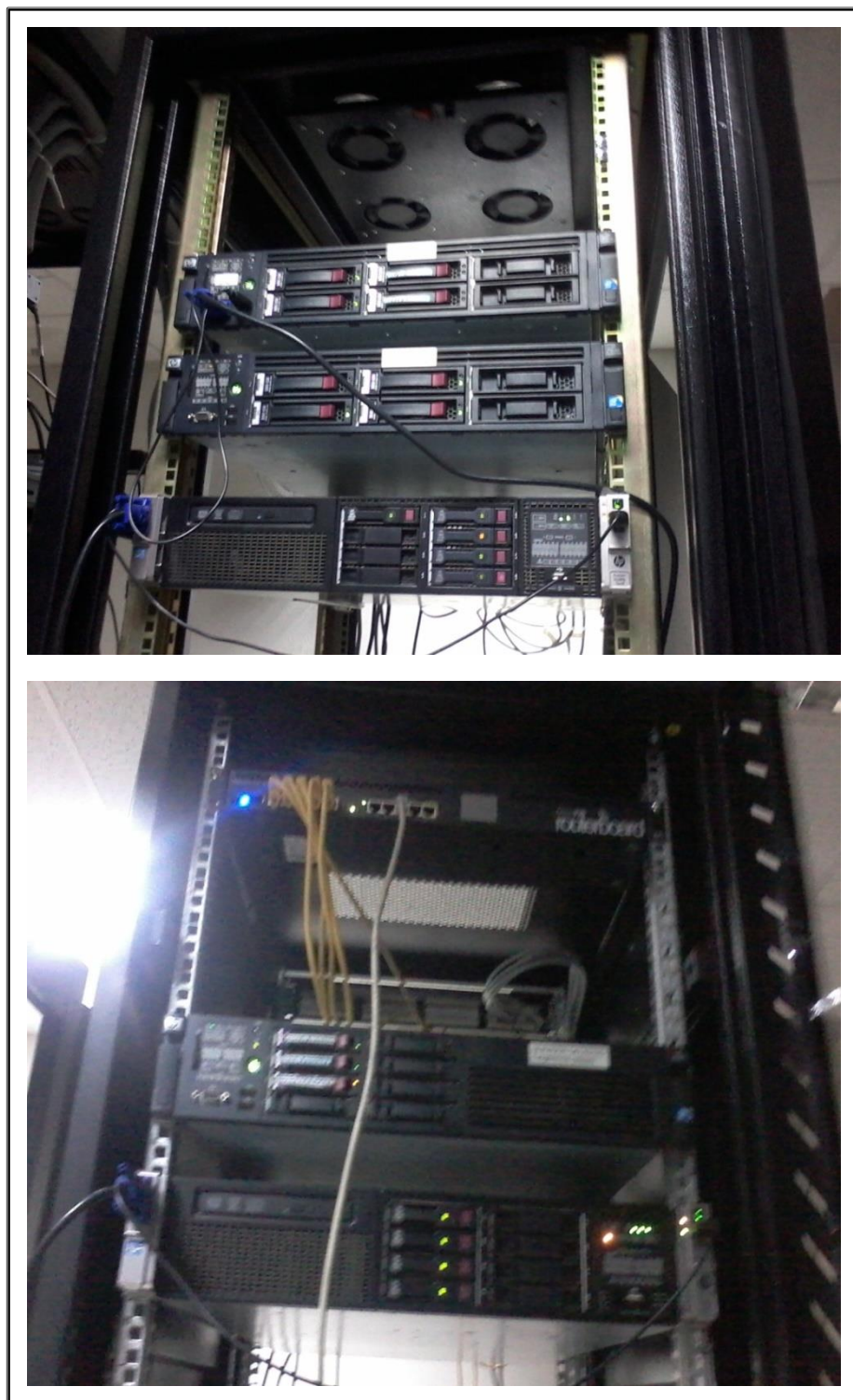
Figura C. 1. Servidores, Racks y Switch de la MPH
