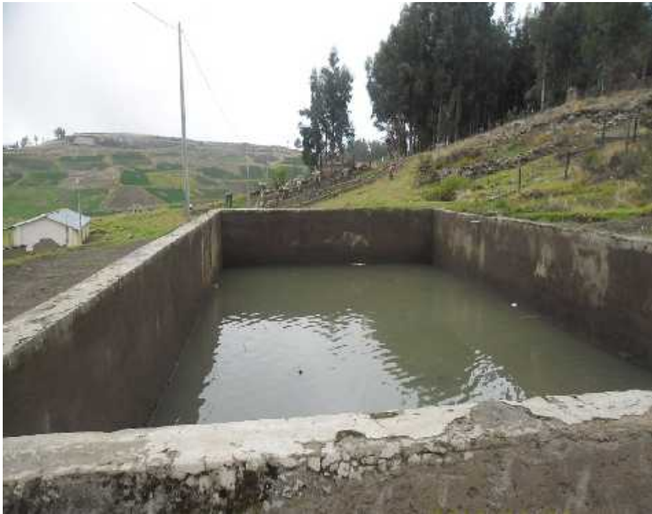
FOTO N° 05: Cámara de carga existente, se encuentra en condiciones regulares - Campanayocc.
