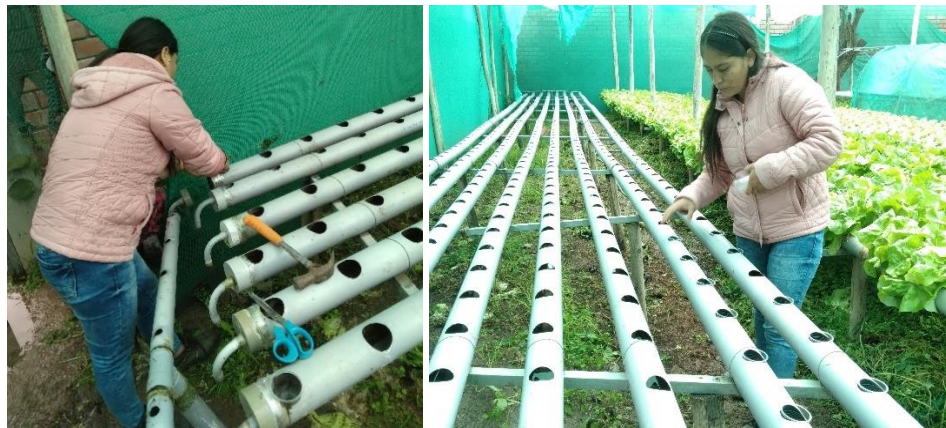
Acondicionamiento del sistema hidropónico
