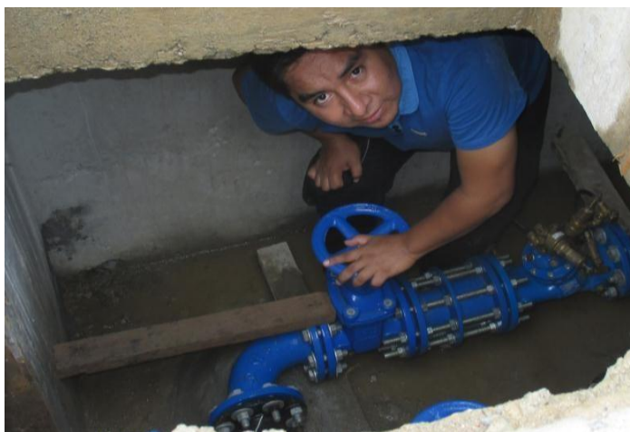
Figura 3.19. Verificación de funcionamiento de VRP.
