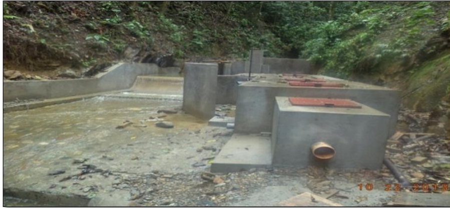
Figura 3.3. Captación y desarenador junto a captación debido a la topografía y roquería encontrada.
