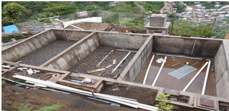
Figura 3.21. Mantenimiento de los 4 filtros lentos se adiciono un 4° filtro
