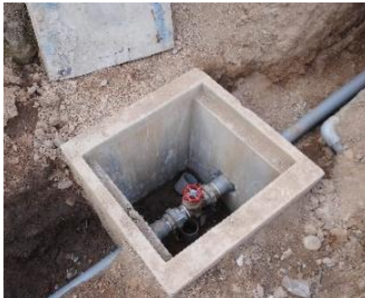
Figura 3.1 8. Válvulas de control para sectorización
