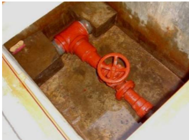
Figura 3.9. Vista de válvulas de purga en redes de distribución
