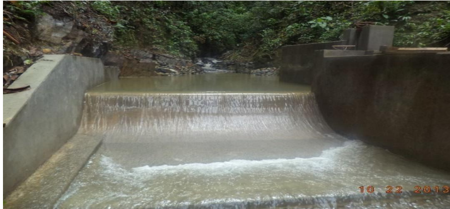
Figura 3.2. Captación terminada en funcionamiento con su barraje respectivo
