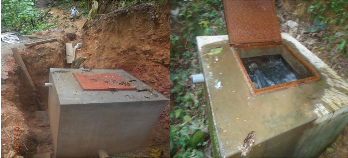
Figura 3.5. CRP tipo VI, en pleno funcionamiento la cual fueron colocados para evitar sobrepresiones en tuberías.
