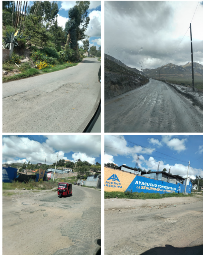
Figura 32 Estado actual de la carretera PE-28A. Fuente: Fotografía propia.
