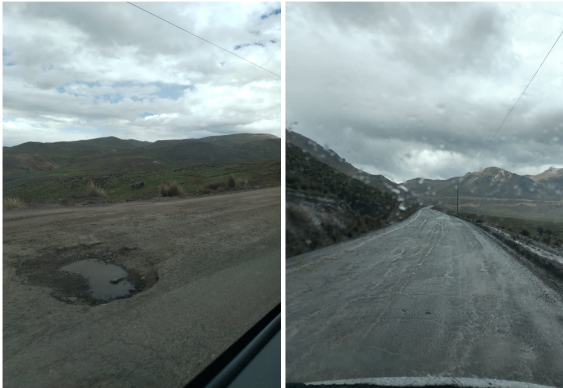
Figura 233 Estado de la Via Los Libertadores - Distr. Pilpichaca. Fuente: Fotografía propia
