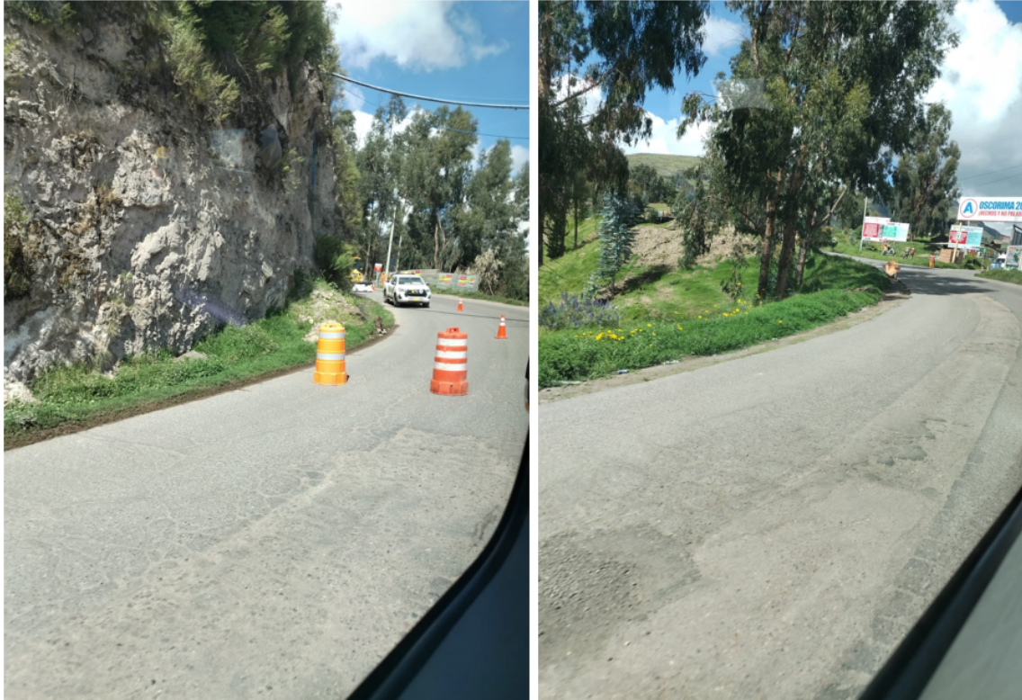
Figura 235 Estado de la Via Los Libertadores - Distr. Socos. Fuente: Fotografía propia
