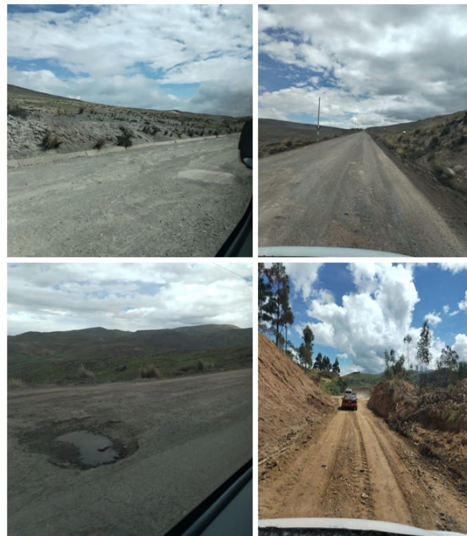
Figura 33 Estado actual de la carretera PE-28A. Fuente: Fotografía propia.
