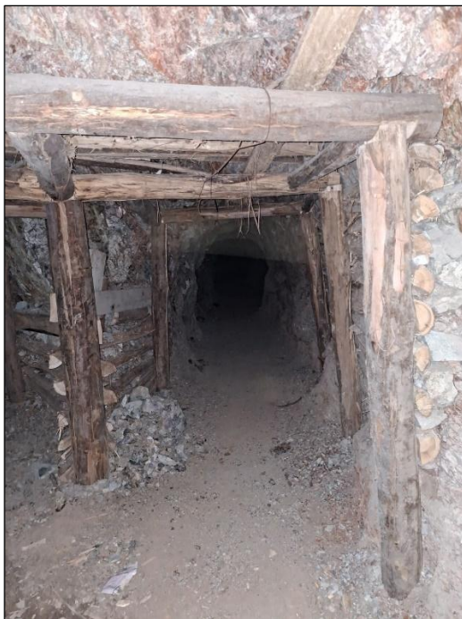
Figura41. Anexo N° 6: Sistema de sostenimiento con cuadros de madera en la Galería 2235.
