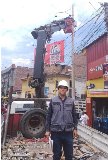
Figura 25: Supervisión de la instalación de cámaras de vigilancia Fuente: Imagen propia
