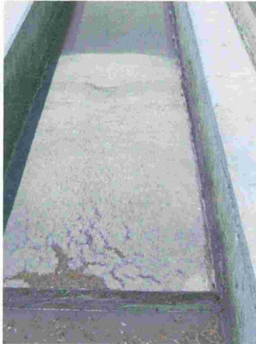
Fotografía Nº 03: Natas acumuladas en la trampa de grasas del desarenador de la Planta de Tratamiento de Aguas Residuales. Ayacucho, 2010.
