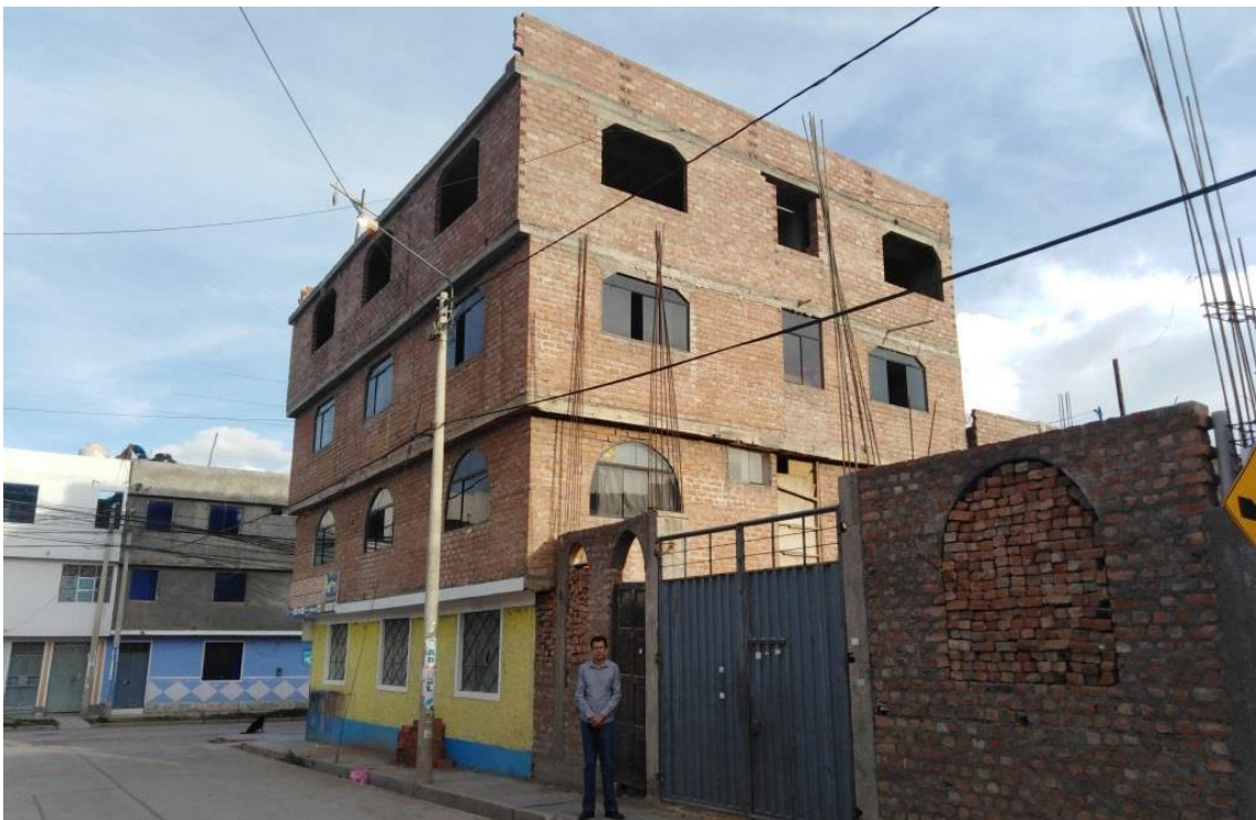
Figura 1.1: Vivienda asociación Covadonga con envolventes ineficientes térmicamente (muros en soga de ladrillo tipo pandereta, ventanas grandes.)
