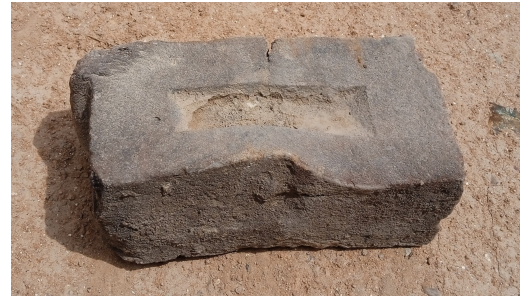
(b) Ladrillos recochados por exceso de quemadura.
