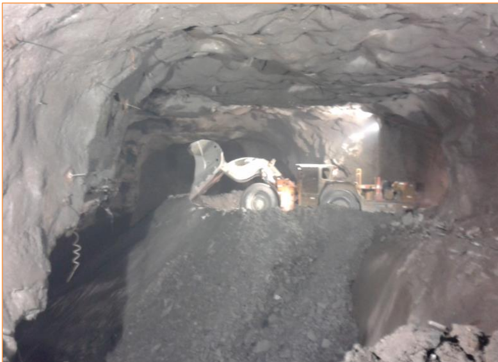
Fig. N° 33: Relleno detrítico en el TJ 4440MC - 1S
