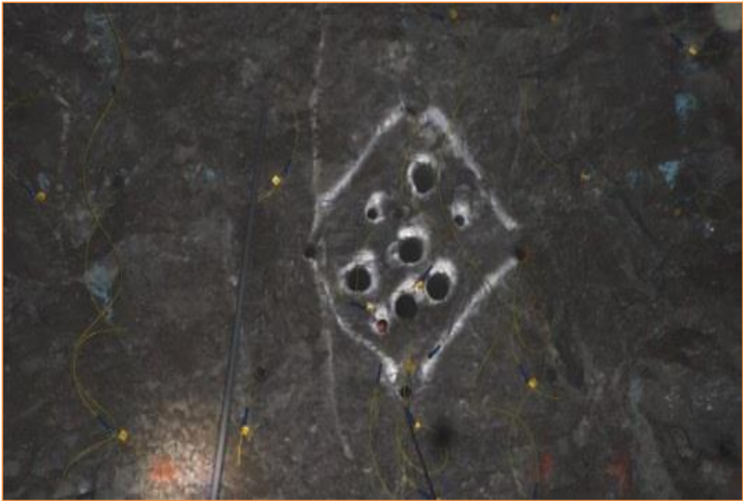
Fig. N° 68: Arranque perforado en la SN 4610 - 2S en Magistral Norte
