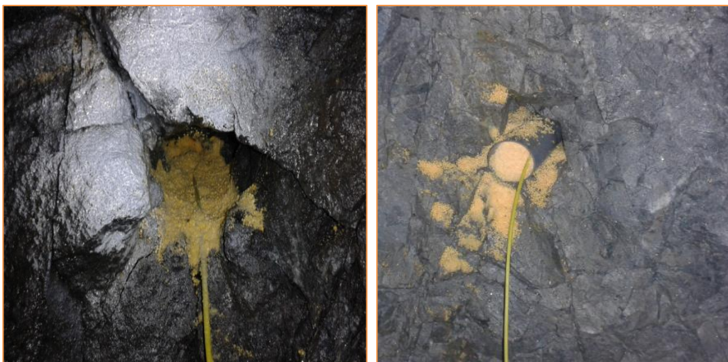
Fig. N° 74: Carga excesiva en los taladros de la corona y hastial
