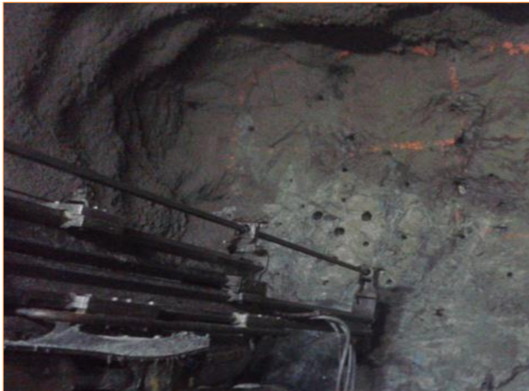
Fig. N° 71: Falta de uso de guidores en el proceso de perforación (RP 4005 - MS)
