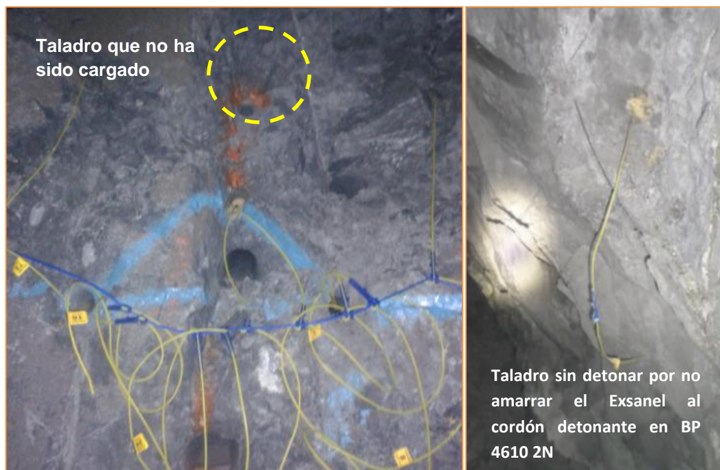
Fig. N° 75: Deficiencia en carguío y distribución de retardos, taladros sin taco
