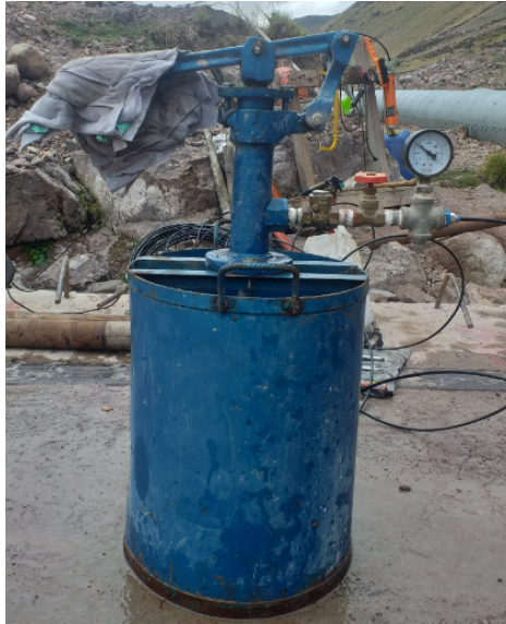
Figura C.39 Tanque de presión de agua. Fuente: Elaboración propia
