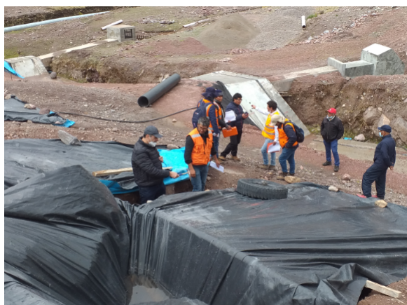
Figura C.31 Ubicación de zonas vulnerables al problema de la infiltración en la presa. Fuente: Elaboración propia
