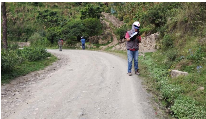
Figura 16. Ahuellamiento reclinado típico en curva
