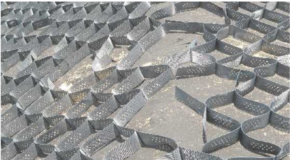
Figura 6.3: Zonas de rotura de geocelda.
