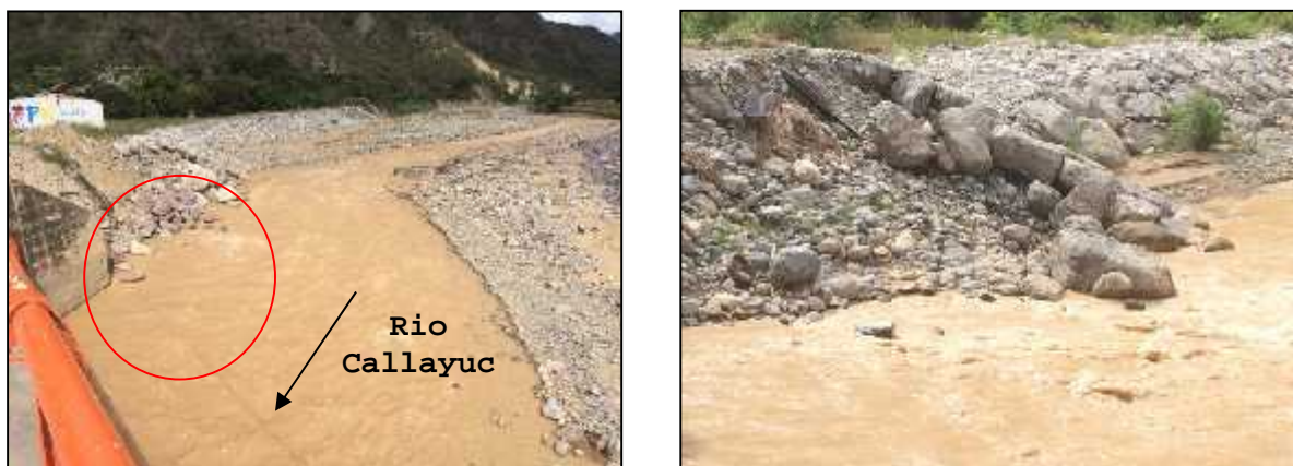
Figura 6.73: Falla del enrocado de protección del estribo derecho del puente Callayuc.
