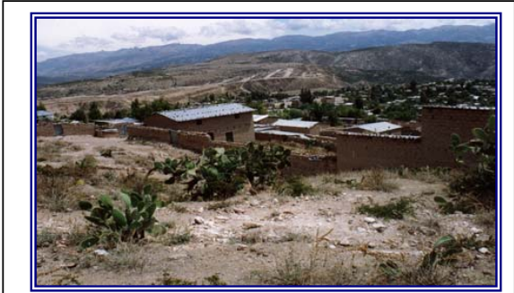
Surcos y cárcavas activas sobre el Sector La Picota – Zona Norte, que causan daño a las cimentaciones
