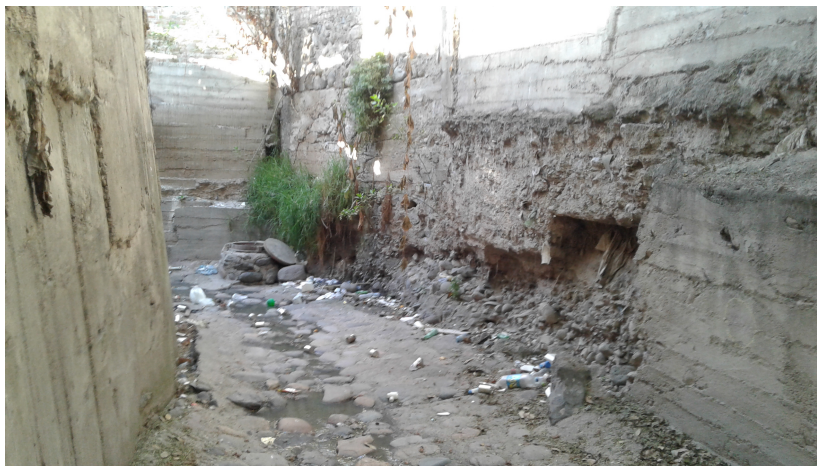
Figura 4.0.2: Se observa la socavación del cemento del muro
