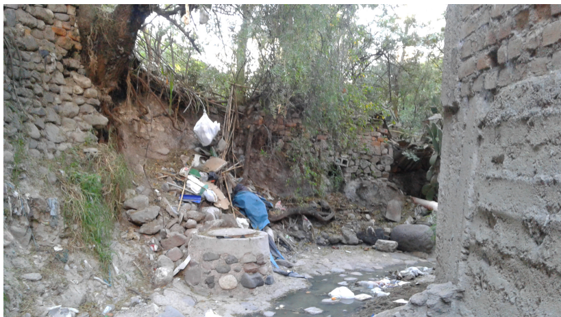
Figura 4.0.4: Red colectora en el canal
