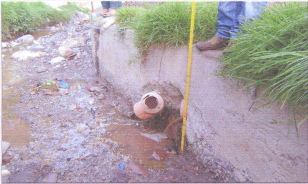
Fotografía N° 09: Desfogue de aguas servidas directamente al afluyente Chaquihuaycco.
