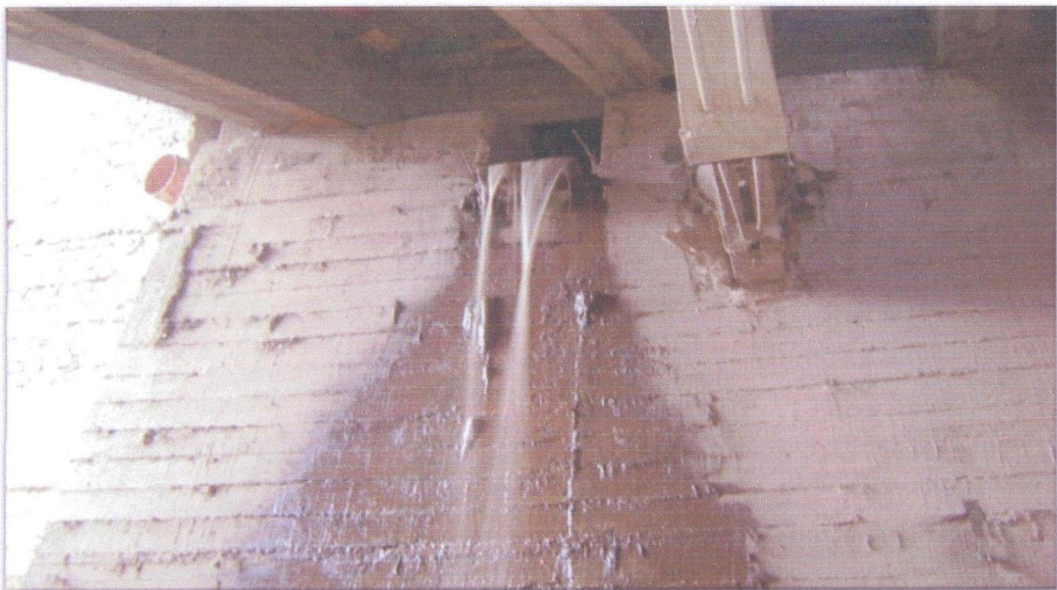
Fotografía N° 10: Inadecuado Desfogue de aguas pluviales.
