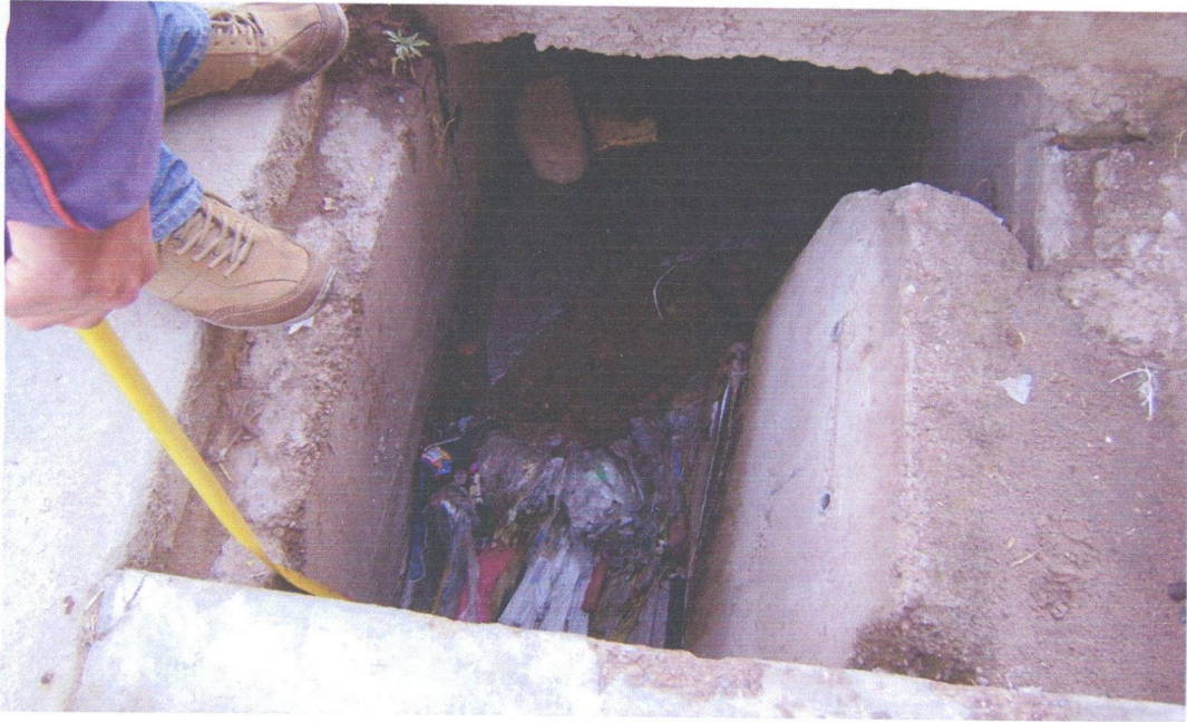
Figura Nº 11: Diagnóstico de las cunetas y colectores en los sectores en estudio.
