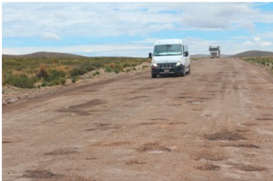
Figura 2.21: Presencia de hoyos (baches) en la plataforma.
