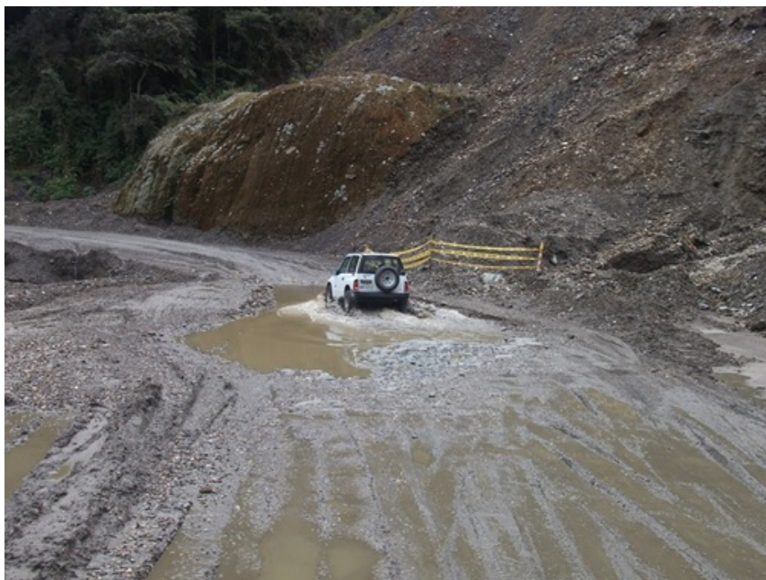
Figura 2.18: Obras de arte sin mantenimiento.
