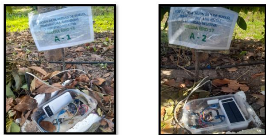
Medición de humedad de suelo, temperatura ambiental y humedad relativa en el Arduino 1 Medición de humedad de suelo, temperatura ambiental y humedad relativa en el Arduino 2
