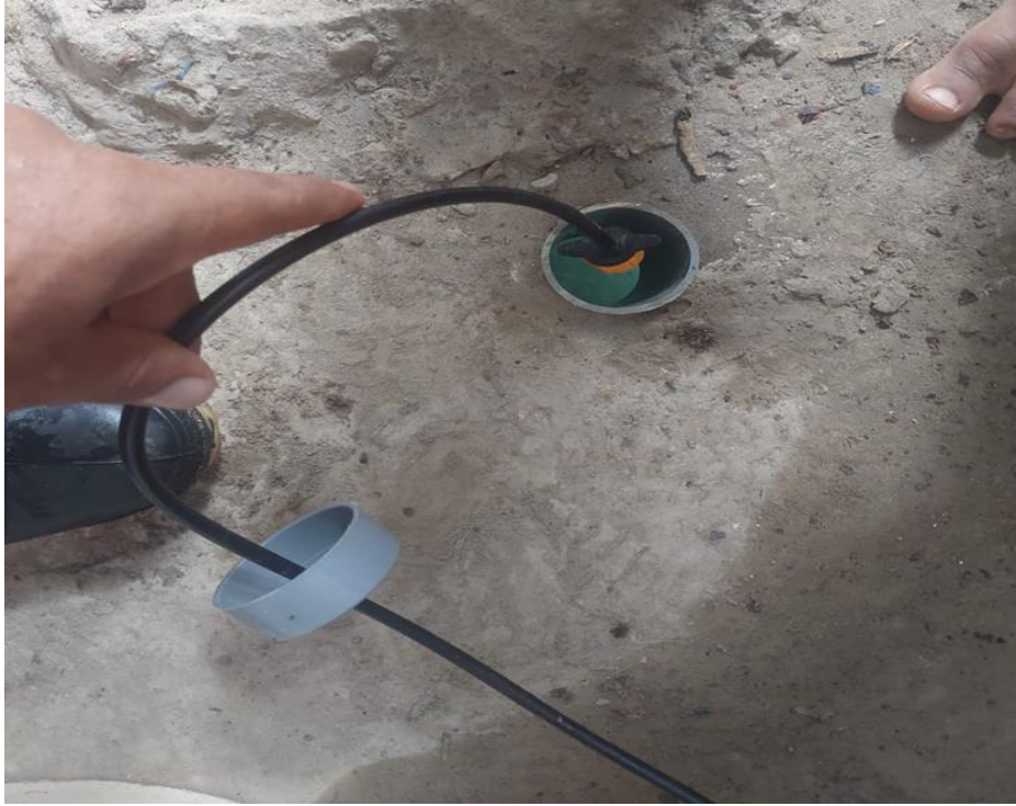
Figura 7.5 Instalación de gotero para la dosis de hipoclorito en solución.
