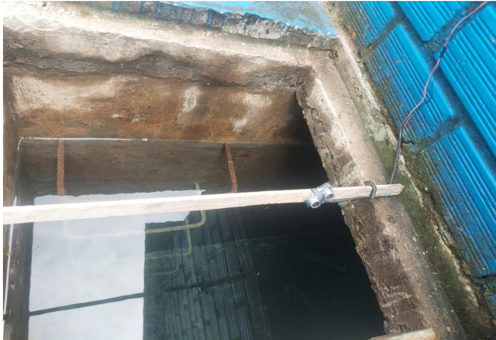
Figura 7.3 Instalación de sensor ultrasónico en reservorio.
