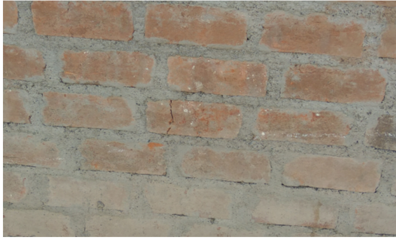
Figura 1.9: Unidad fisurada en muro de albañilería confinada.
