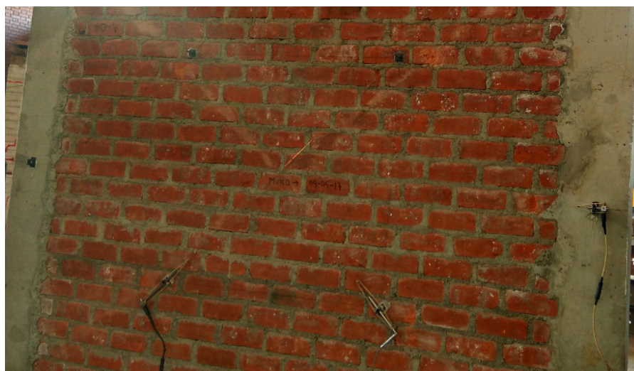
Figura 3.57: Sensores en el muro de albañilería.
