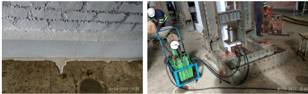
Figura 3.53: Nivelación del muro con capping de yeso - cemento y fijación con gatas hidráulicas.
