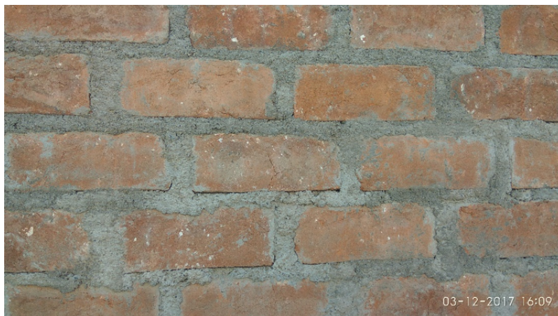
Figura 1.10: Espesor de juntas desiguales en muros de albañilería.
