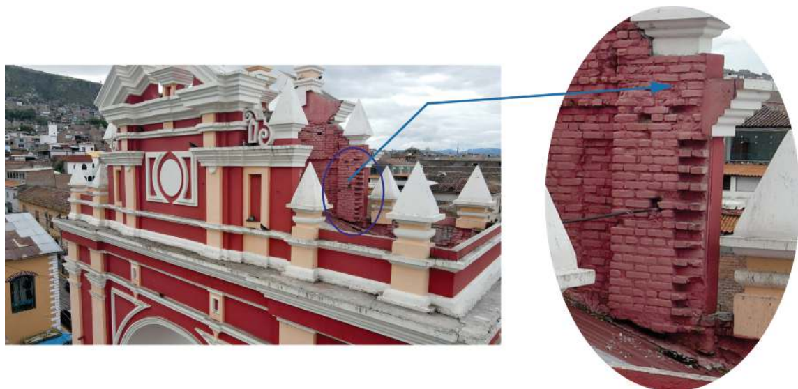
Figura 70 Identificación de deterioro en la parte superior derecho del monumento.
