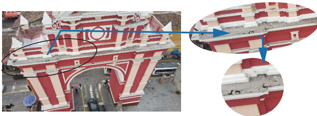
Figura 72 Identificación de daños y lesiones del lado izquierdo la edificación histórica.
