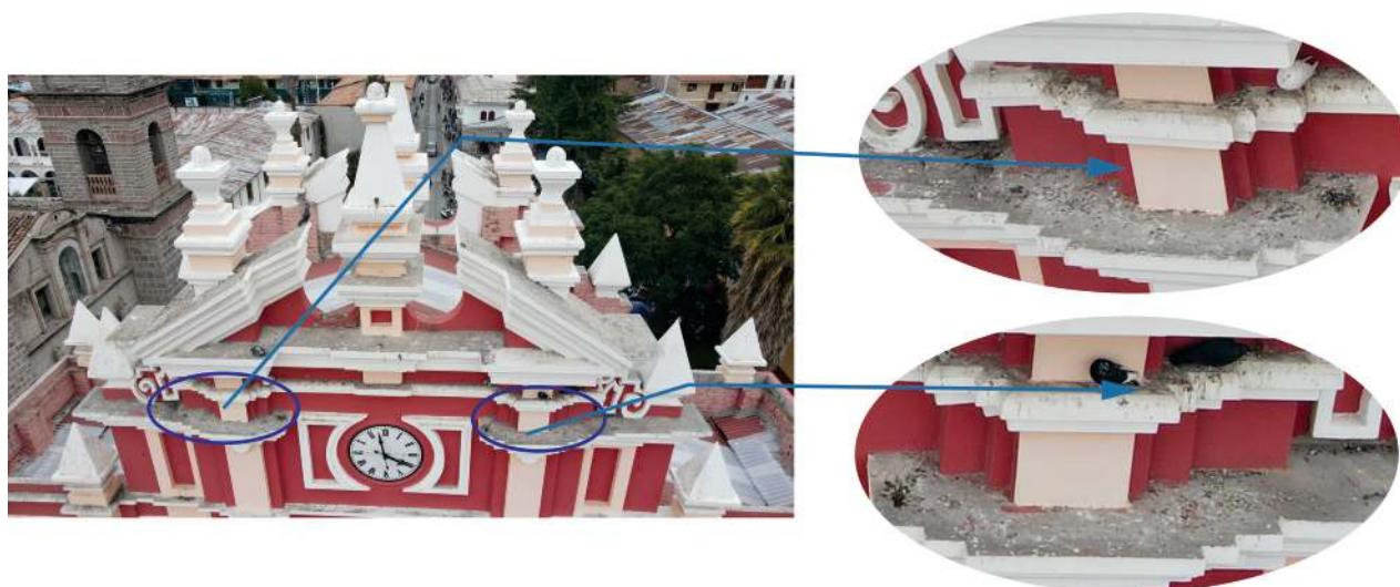
Figura 68 Proceso de identificación de daños y deterioros en la parte superior de la edificación.
