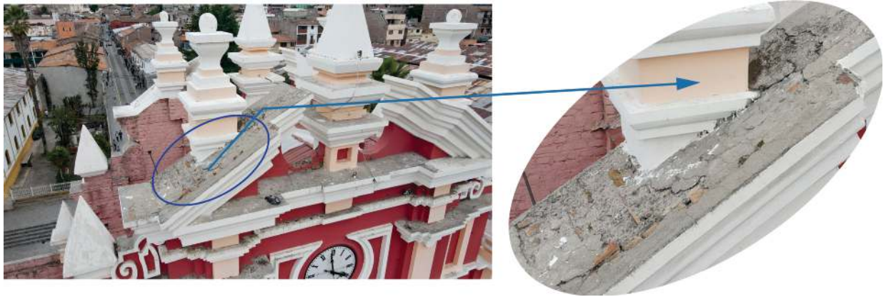
Figura 69 Identificación de deterioro en la parte superior derecho del monumento.
