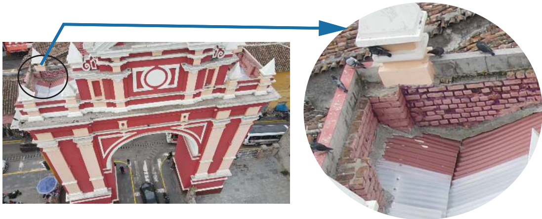
Figura 73 Identificación de daños y lesiones de la edificación histórica.
