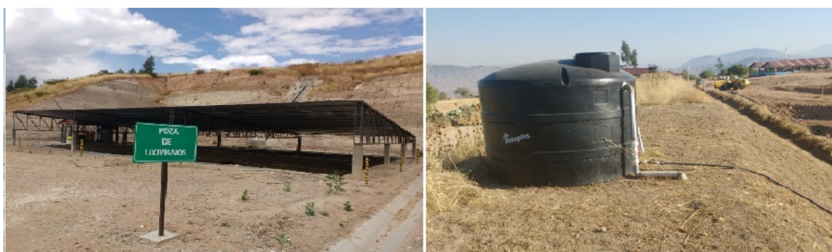
Figura 22 Poza de lixiviados y tanque de recirculación
