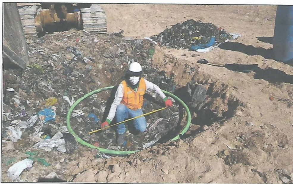
Fotografía N°02. Medición de las dimensiones del hoyo formado.
