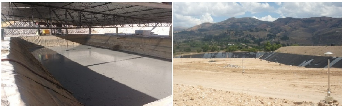
Figura 28 Descarga de lixiviados en pozas; y gases a través de chimeneas
