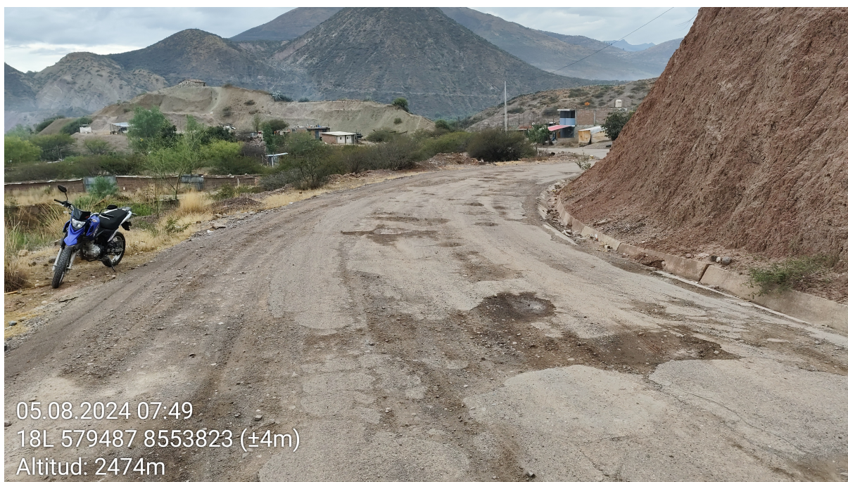
Figura 25: Deterioro en curva km 5+350 del tramo EMP.PE-26B
