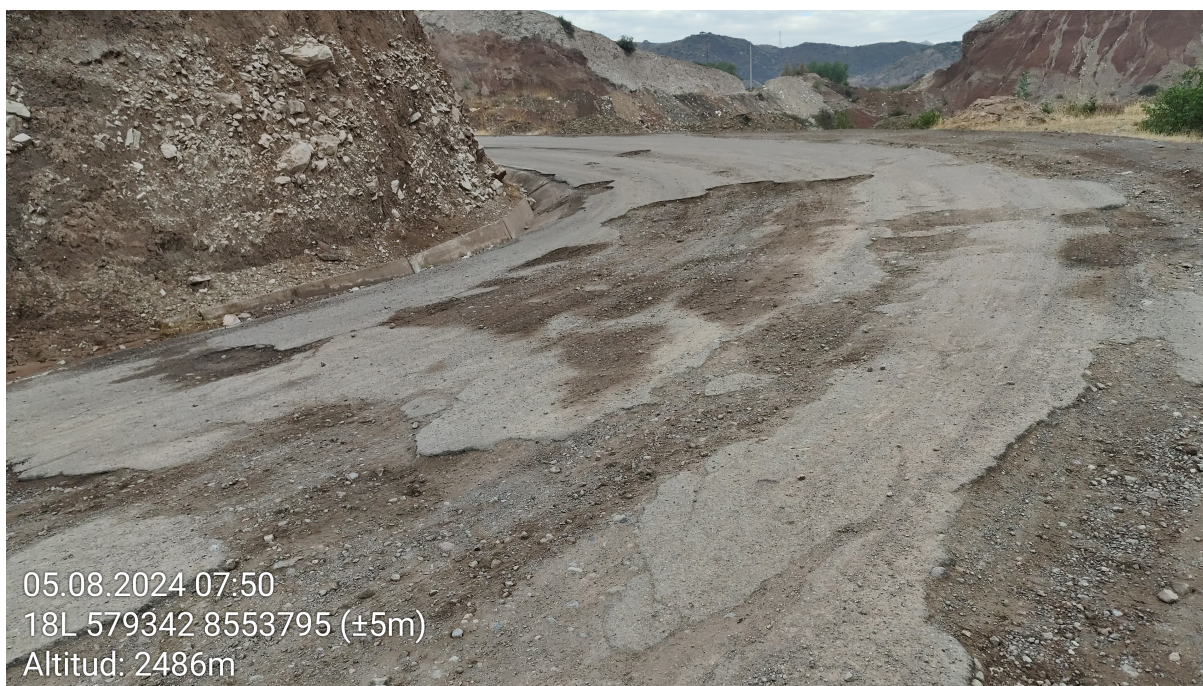
Figura 21: Deterioro en curva km 5+500 del tramo EMP.PE-26B
