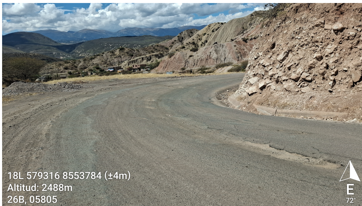
Figura 23: Deterioro en curva km 5+550 del tramo EMP.PE-26B
