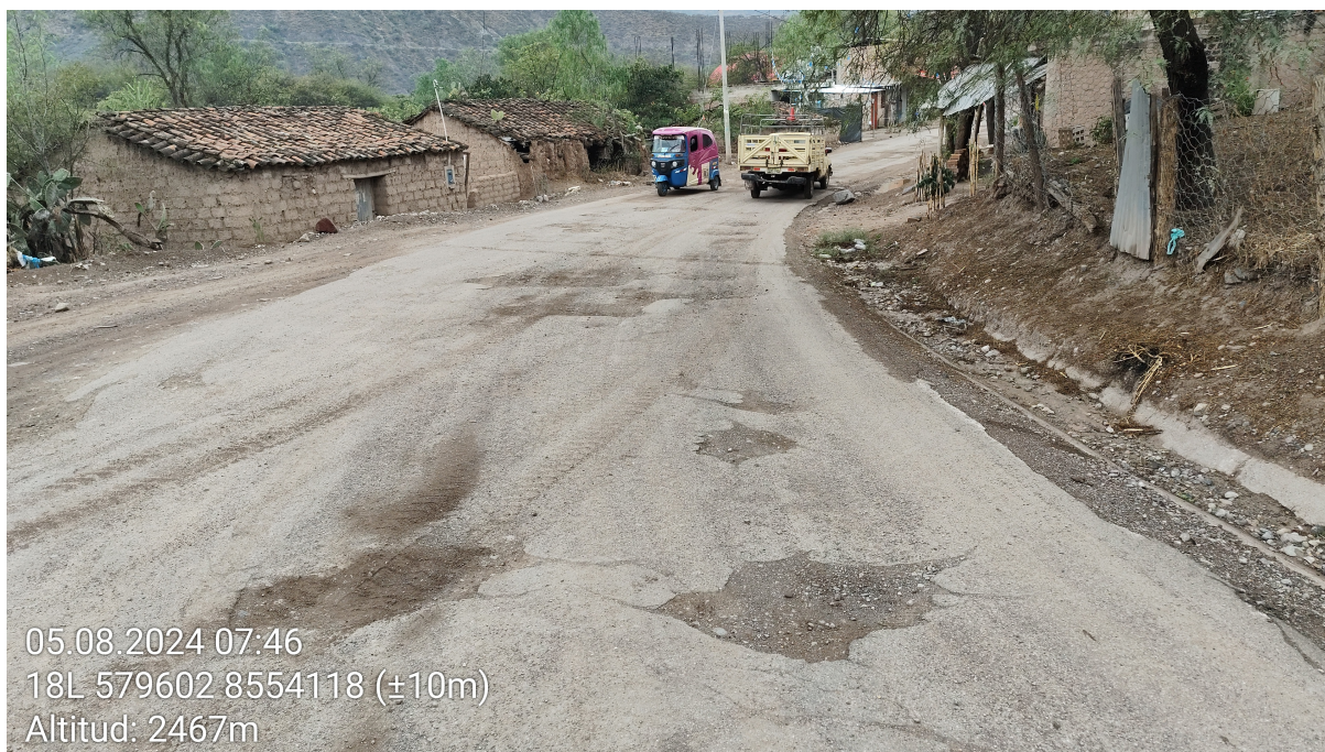
Figura 22: Deterioro en curva km 5+050 del tramo EMP.PE-26B
