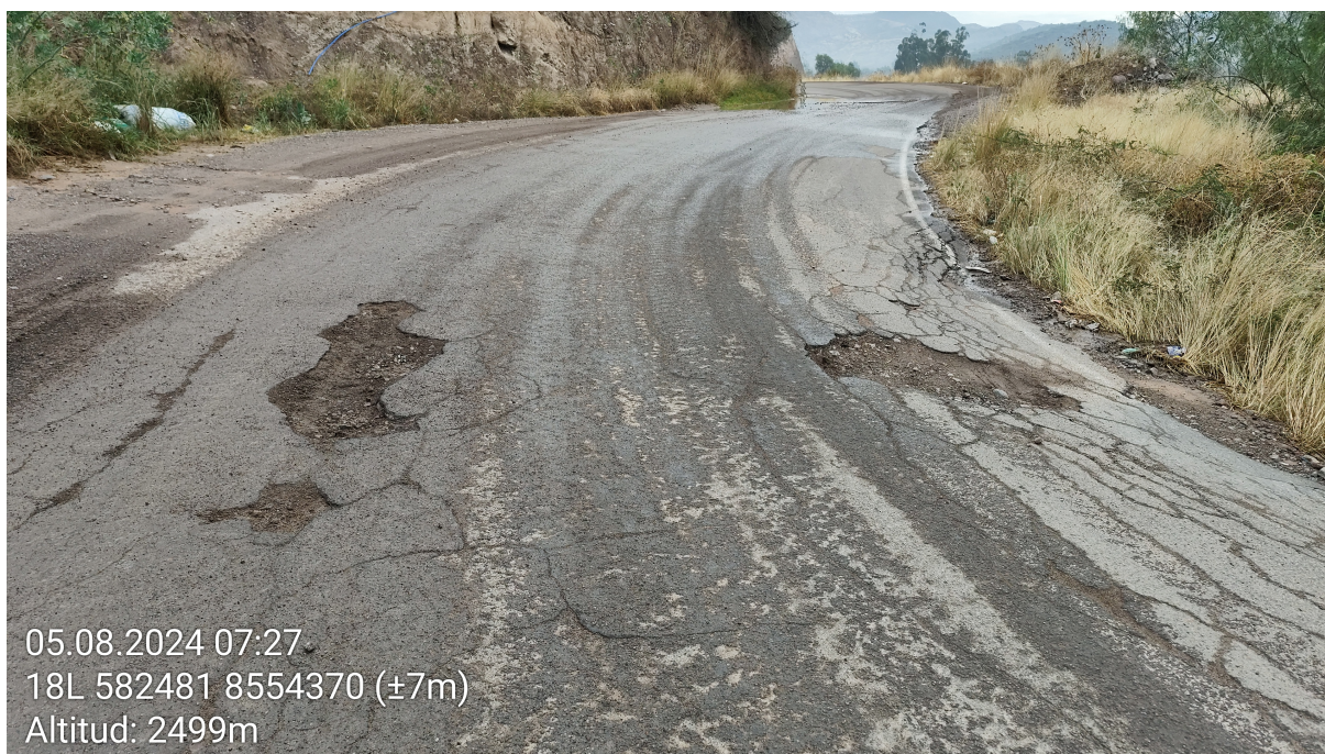
Figura 19: Deterioro en curva km 1+200 del tramo EMP.PE-26B
