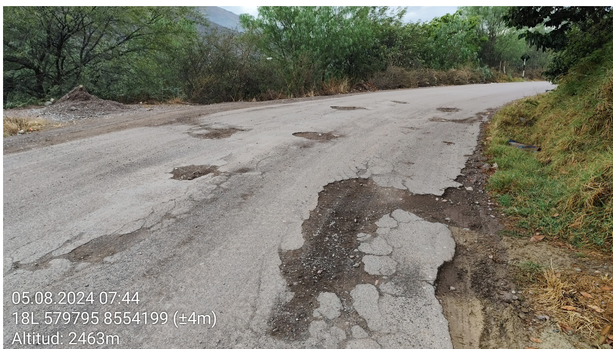
Figura 20: Deterioro en curva km 4+900 del tramo EMP.PE-26B
