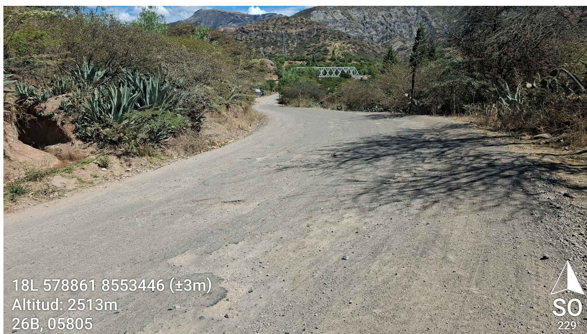
Figura 24: Deterioro en curva km 6+300 del tramo EMP.PE-26B
