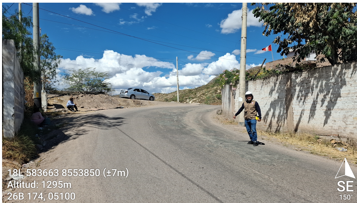
Figura 17: Deterioro en curva km 0+100 del tramo EMP.PE-26B con recapeo rutinario
