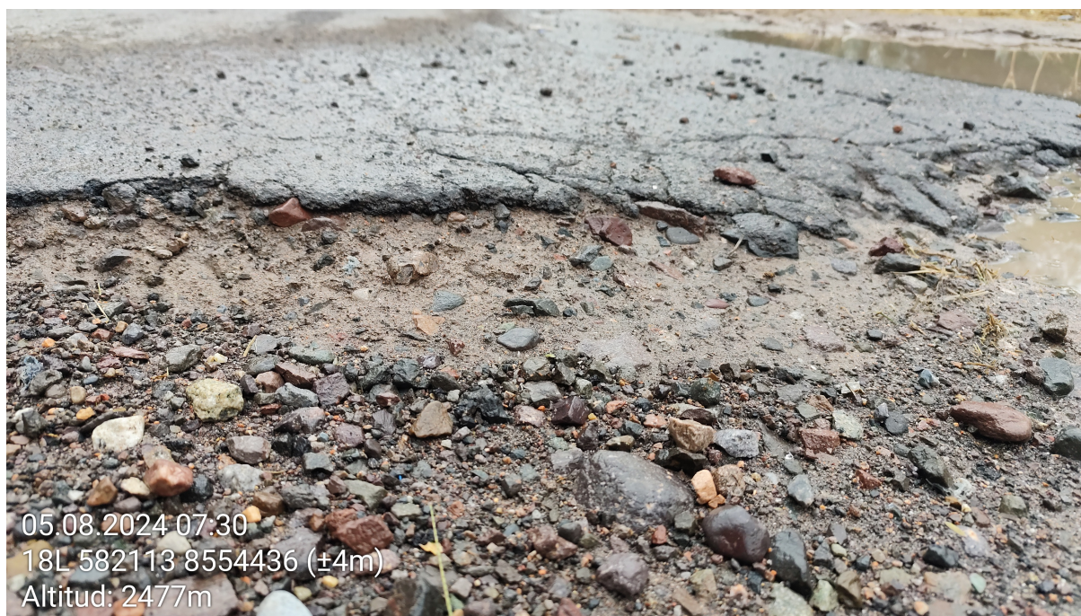
Figura 18: Capas estructurales de micropavimento deteriorado
