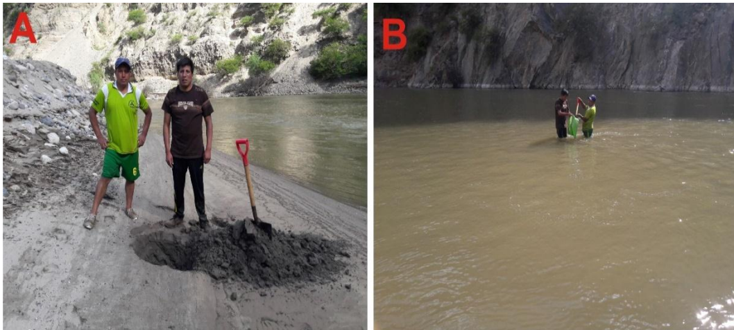
Figura 63: Excavación de calicata para caracterizar la granulometría del material sub superficial después de la época húmeda.
