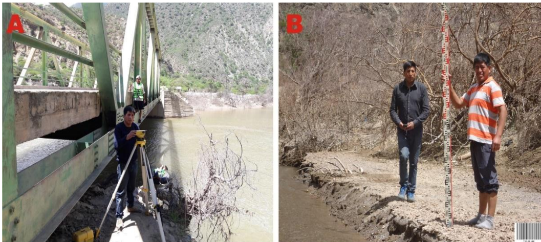
Figura 24: Trabajos de topografía hidrográfica en el cauce del río, A) Nivel de ingeniero, B) determinación de las cotas mínimas de cada sección del río en una longitud de 400.00 m.
