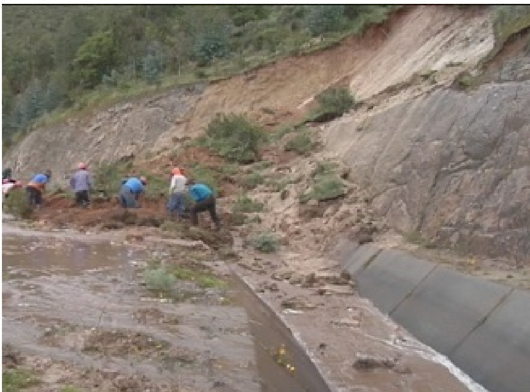
Figura 4 Deslizamiento del talud en el canal del ex proyecto Río Cachi, ubicado en el centro poblado de Chupas distrito de Chiara.
