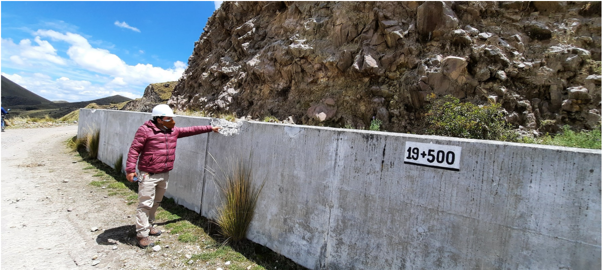
Figura 63 Punto 38 zona de riesgo tramo: Apacheta - Choccoro en el Canal del ex PERC.
