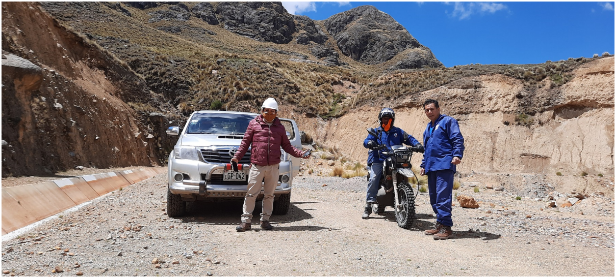
Figura 28 Punto 03 de la zona de riesgo tramo: Apacheta - Choccoro en el canal del ex PERC. Fuente: Elaboración Propia
