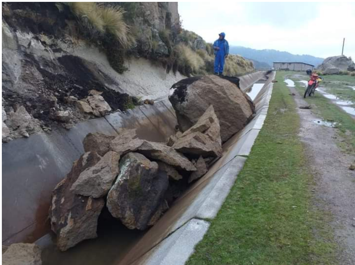
Figura 2 Caída de rocas en el Canal del ex Proyecto Río Cachi
