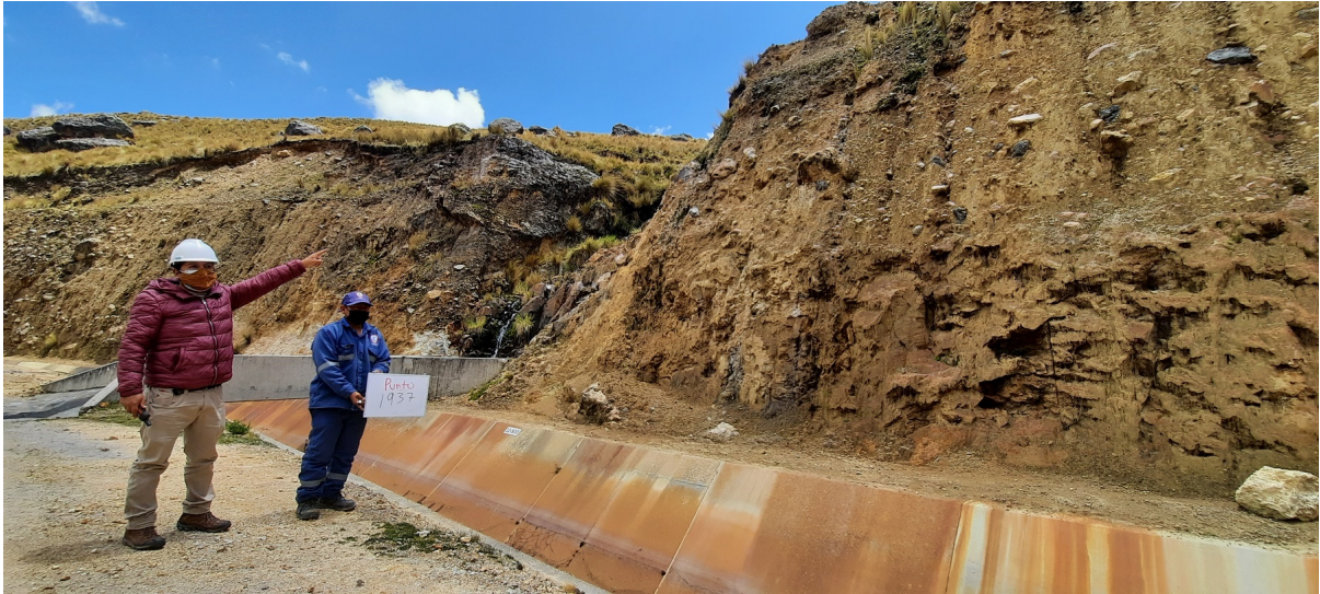
Figura 44 Punto 19 zona de riesgo tramo: Apacheta - Choccoro en el Canal del ex PERC.
