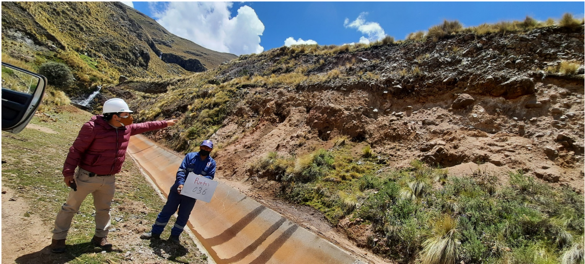
Figura 54 Punto 29 zona de riesgo tramo: Apacheta - Choccoro en el Canal del ex PERC. Fuente: Elaboración Propia
