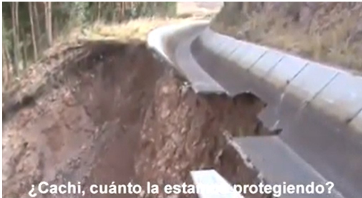
Figura 1 Colapso del canal en Km 17+000, Satica - Munaypata.
