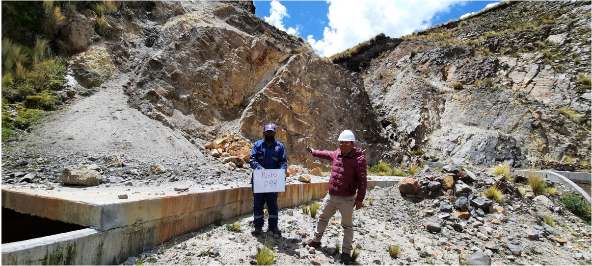
Figura 60 Punto 35 zona de riesgo tramo: Apacheta - Choccoro en el Canal del ex PERC.
