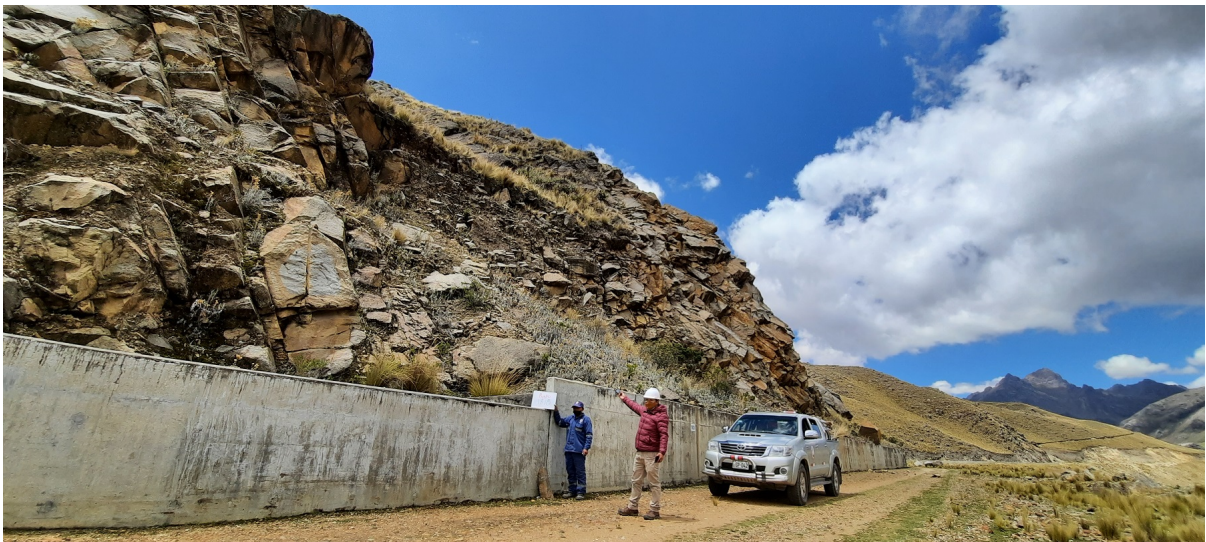
Figura 33 Punto 08 de la zona de riesgo tramo: Apacheta - Choccoro en el Canal del ex PERC. Fuente: Elaboración Propia
