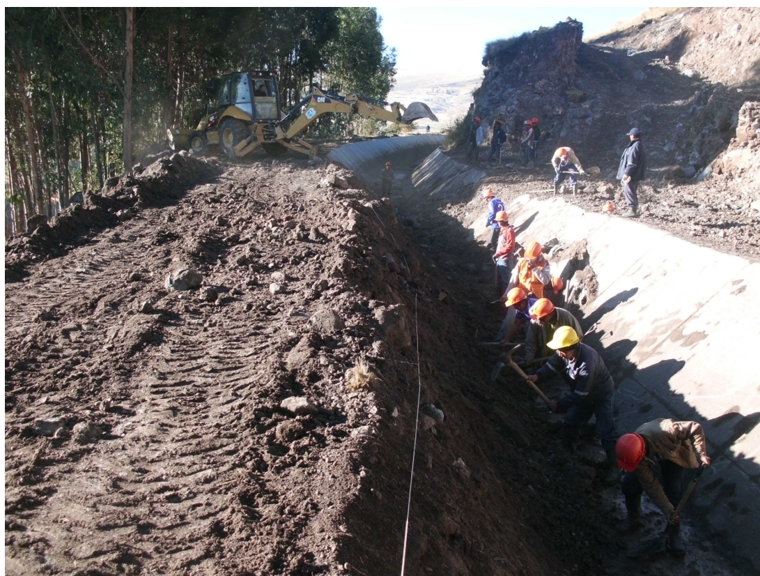
Figura 10 Obstrucción parcial en el canal Cachi. Fuente: Fuente OPEMAN
