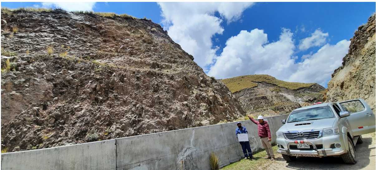
Figura 61 Punto 36 zona de riesgo tramo: Apacheta - Choccoro en el Canal del ex PERC.
