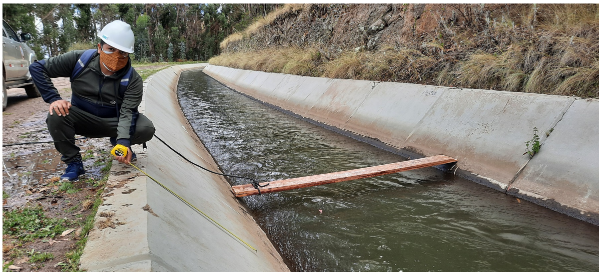
Figura 81 Vista del borde libre, la marca de agua en el concreto del canal.
