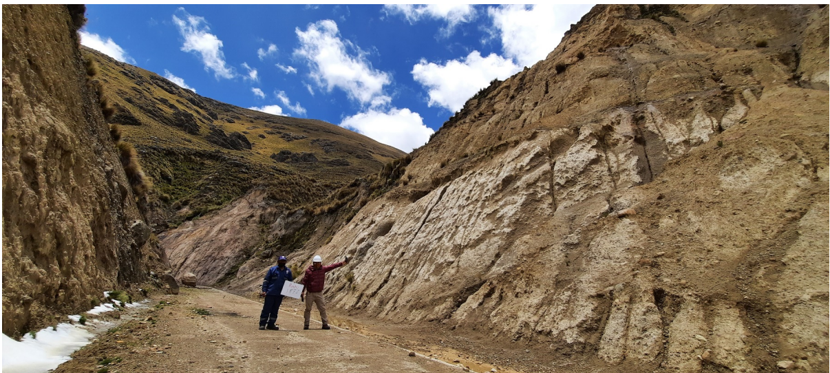
Figura 37 Punto 12 zona de riesgo tramo: Apacheta - Choccoro en el Canal del ex PERC. Fuente: Elaboración Propia
