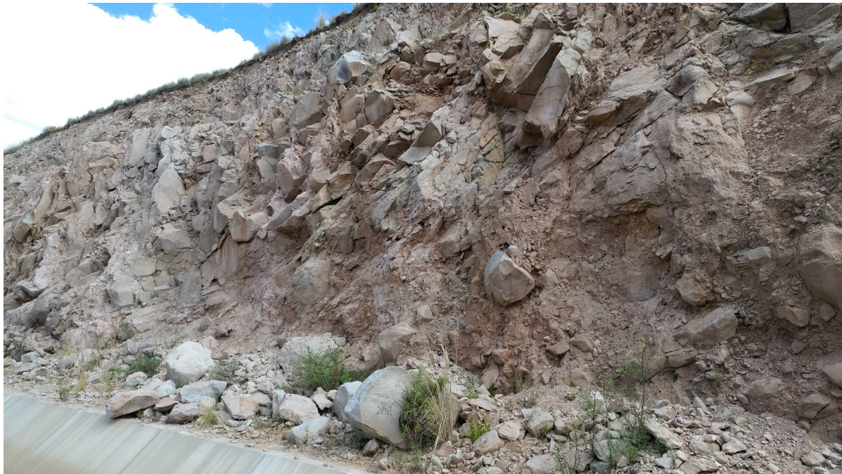
Figura 80 Punto 46 zona de riesgo en Satica KM 17+370, en el Canal del ex PERC.
