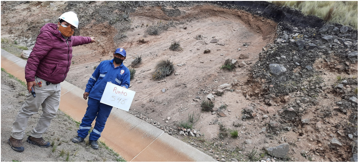
Figura 66 Punto 40 zona de riesgo tramo: Apacheta - Choccoro en el Canal del ex PERC.
