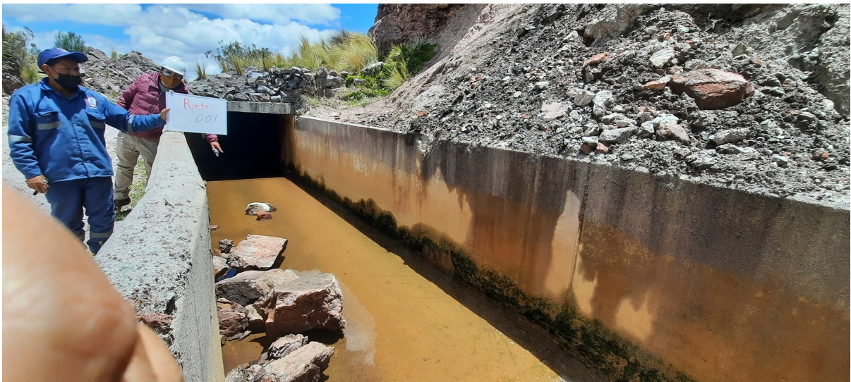
Figura 49 Punto 24 zona de riesgo tramo: Apacheta - Choccoro en el Canal del ex PERC. Fuente: Elaboración Propia
