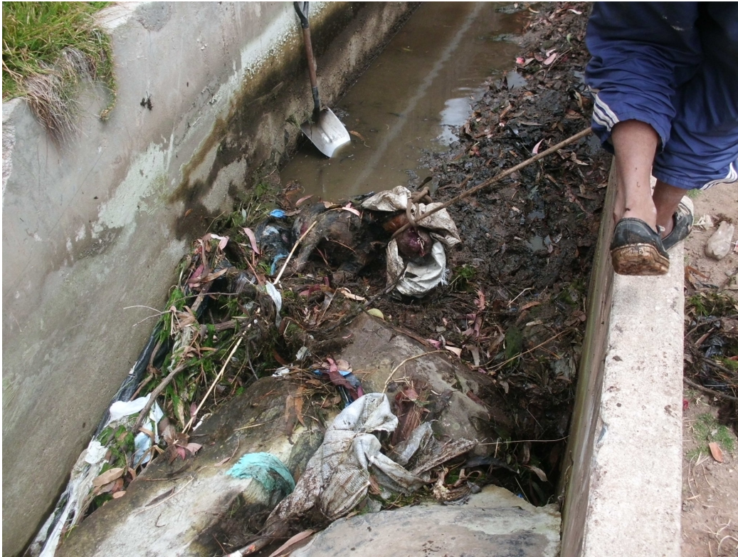
Figura 5 Obstrucción del canal por caídas de rocas, animales y desechos que arrastra el flujo de agua en el canal del ex proyecto Río Cachi.
