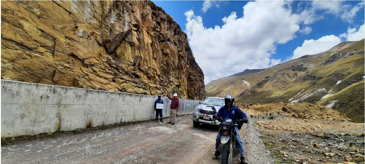
Figura 45 Punto 20 zona de riesgo tramo: Apacheta - Choccoro en el Canal del ex PERC.
