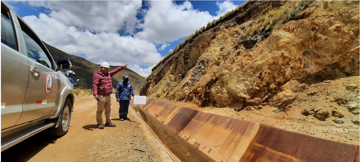
Figura 42 Punto 17 zona de riesgo tramo: Apacheta - Choccoro en el Canal del ex PERC. Fuente: Elaboración Propia
