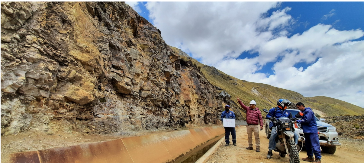
Figura 39 Punto 14 zona de riesgo tramo: Apacheta - Choccoro en el Canal del ex PERC.
