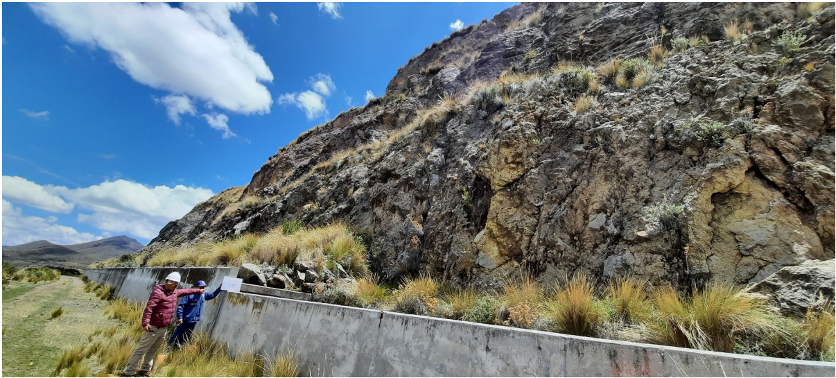
Figura 58 Punto 33 zona de riesgo tramo: Apacheta - Choccoro en el Canal del ex PERC.
