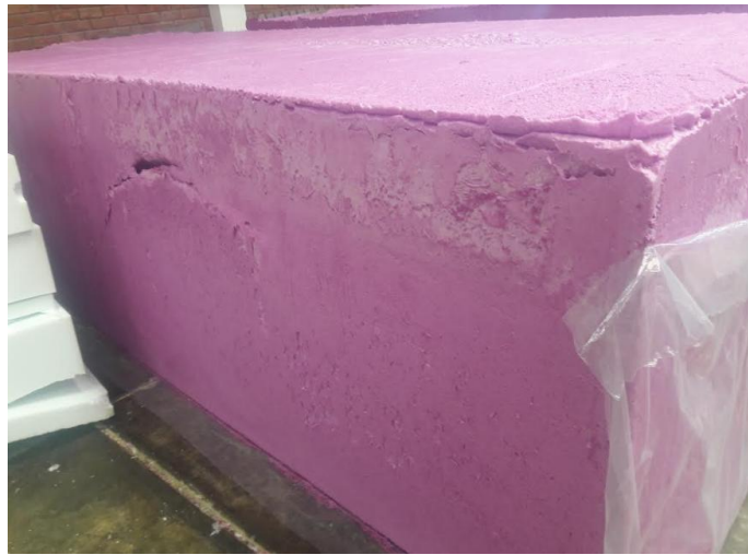
Exceso de catalizador de amina.
