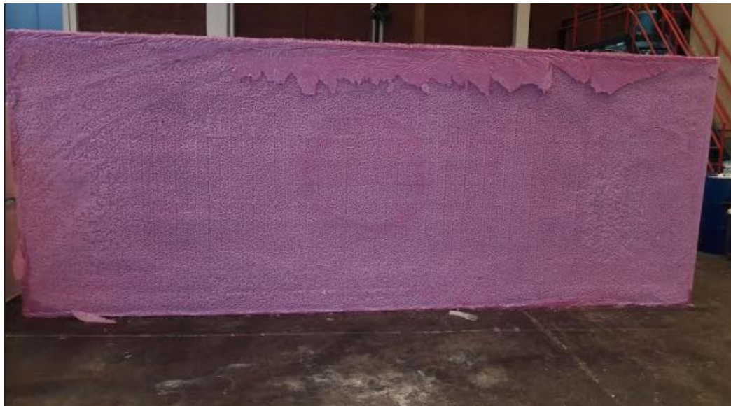
Exceso de catalizador de estaño.
