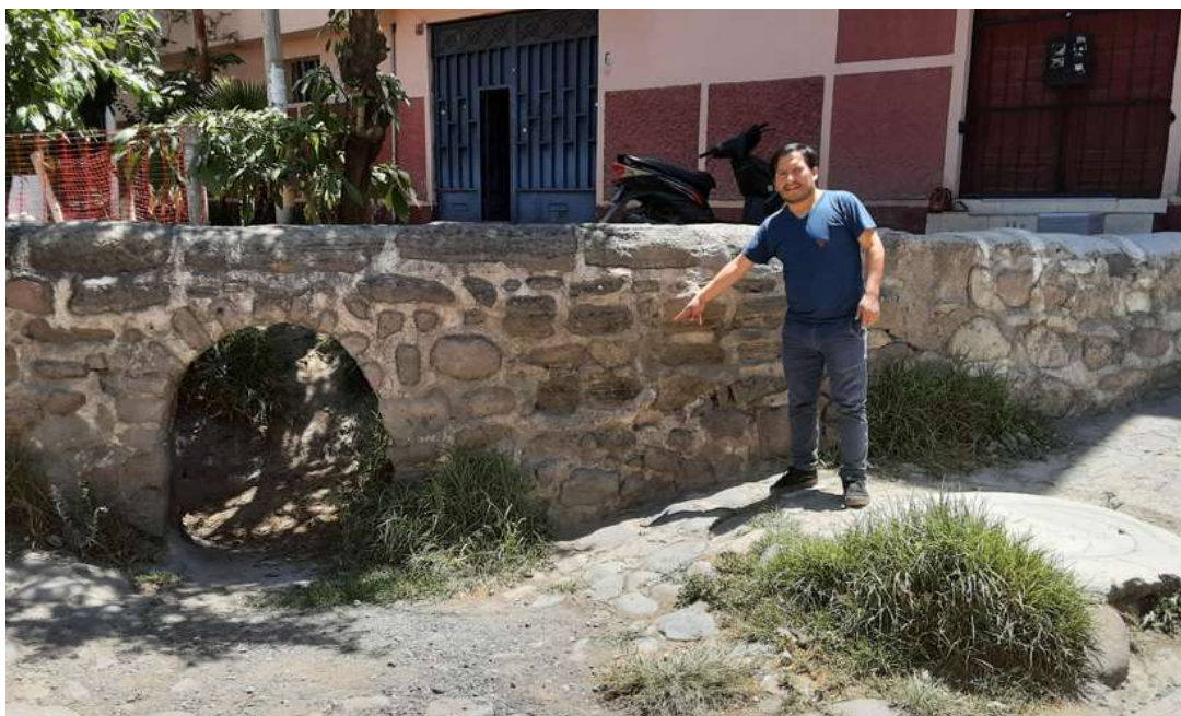
Figura 3.7: Daños estructurales en el puente San Sebastian.
