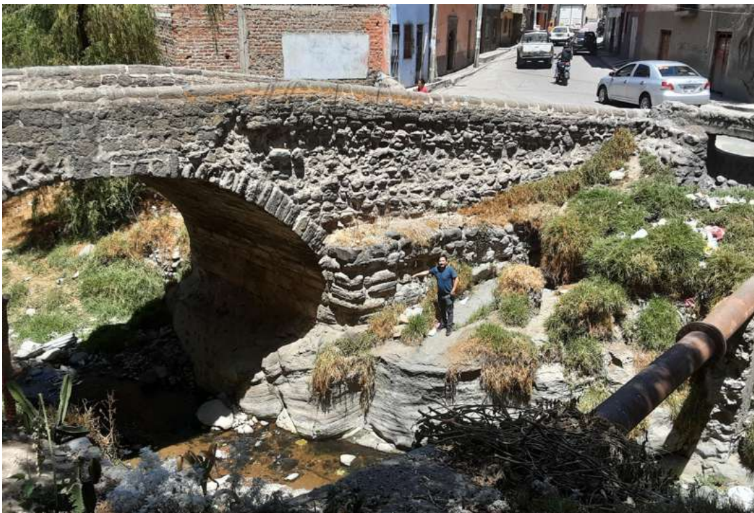
Figura 3.6: Daños estructurales en el puente San Sebastian.
