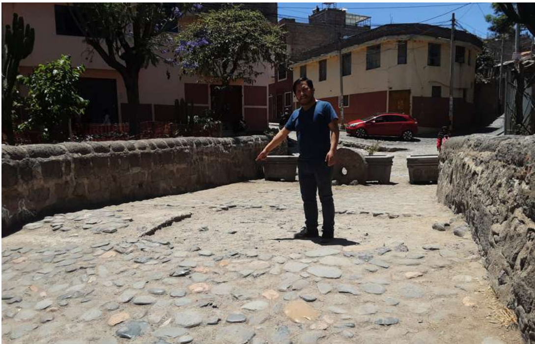
Figura 3.4: Daños estructurales en el puente San Sebastian.
