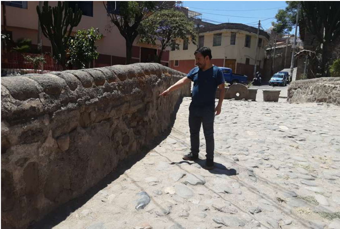
Figura 3.2: Daños estructurales en el puente San Sebastian.
