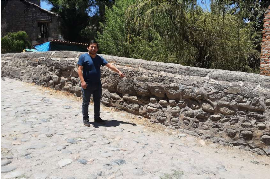
Figura 3.3: Daños estructurales en el puente San Sebastian.
