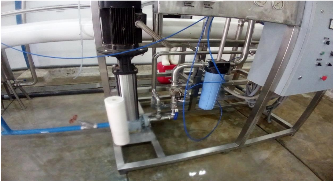
Imagen N°03: Filtro cartucho incorporado al proceso de producción de agua de mesa ozonizada.
