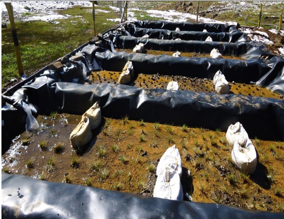
Fotografía 07. Wedland para el tratamiento de aguas de la bocamina Pampamachay.
