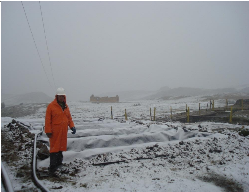
Fotografía 06. Tuberías de abastecimiento de aguas de la bocamina Pampamachay.
