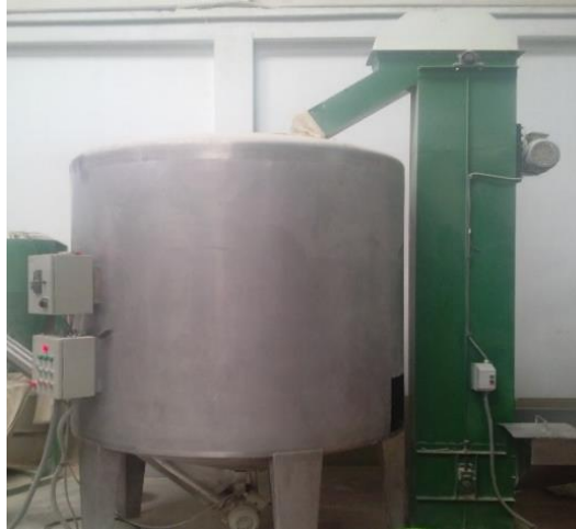
Figura n° 4.3: Vista de tanque pulmón.
