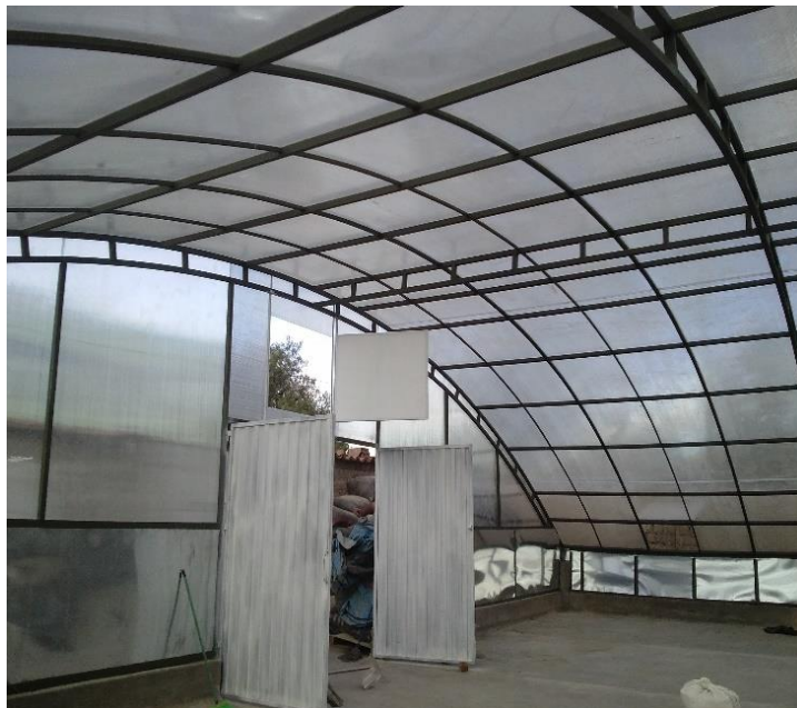
Figura n° 4.24: Vista de la ventana principal de ventilación.
