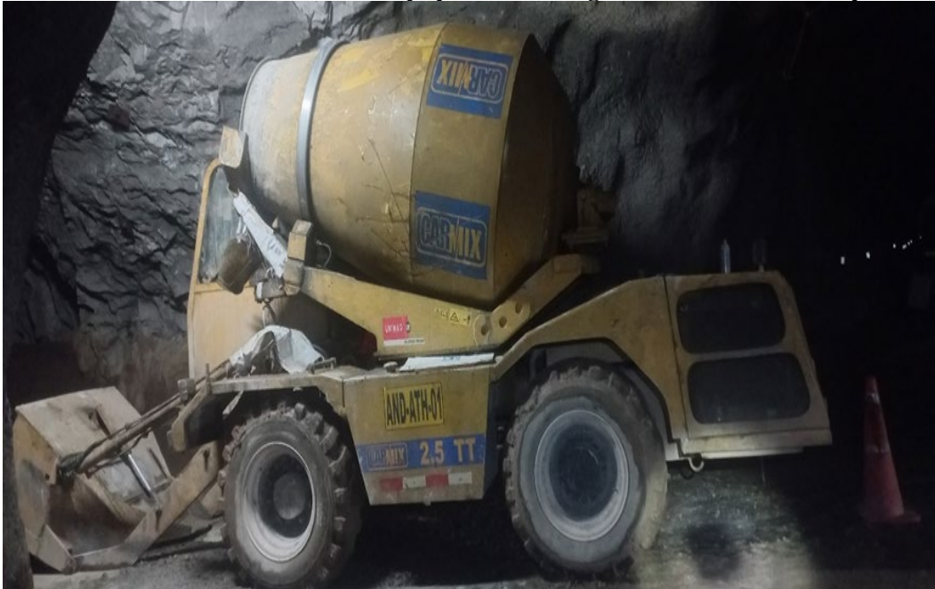
Figura 63. Vaciado de los anillos de concreto con equipo autohormigonera Carmix en el Pique Carlos
