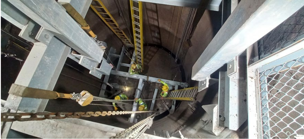
Figura 70. Guías metálicas instaladas en la columna del Pique Circulara Carlos
