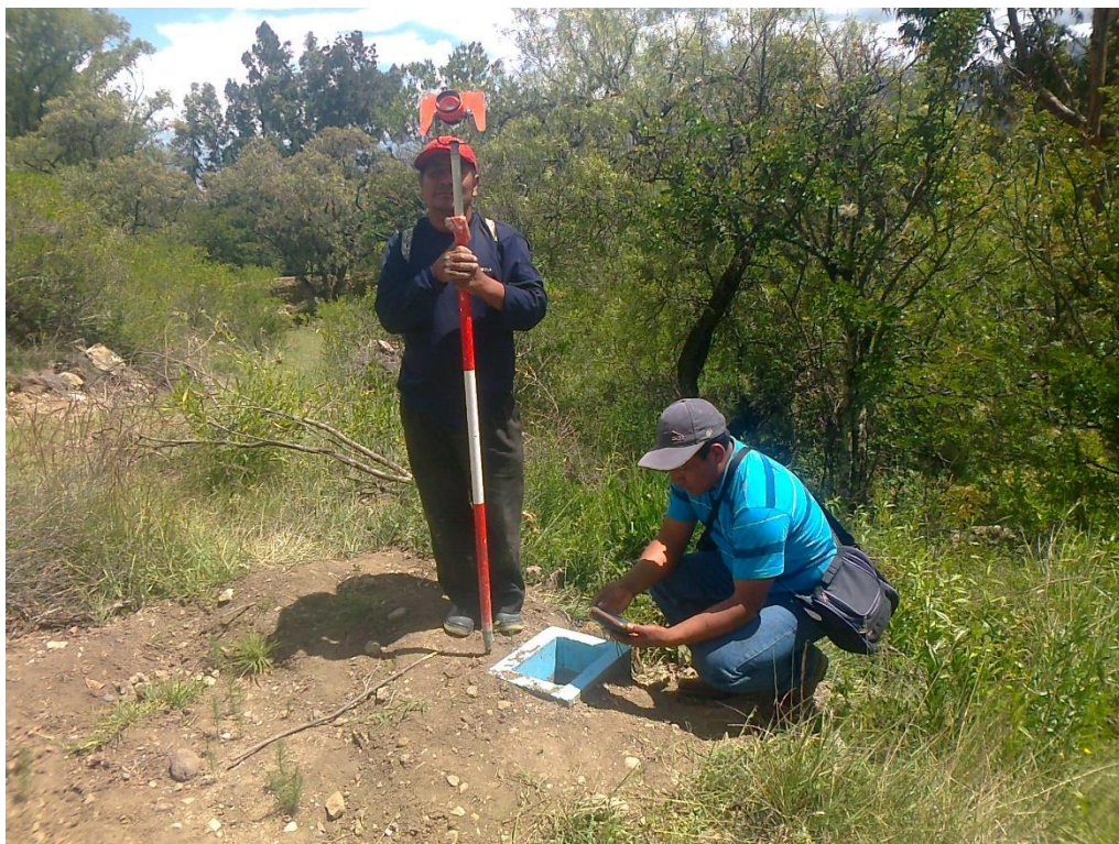
Foto 4. Ubicación de válvula de purga con estación total, se observa el prisma tomando lectura.
