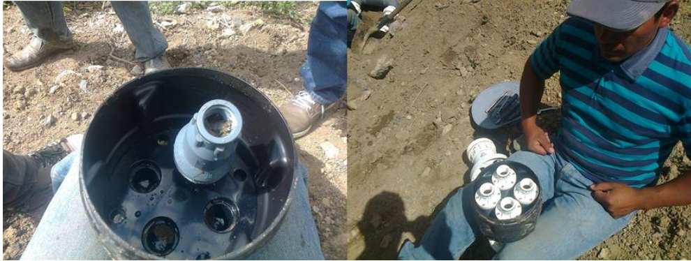
Figura 11: Se observa la acumulación de arena en cada uno de los reguladores en el interior.
