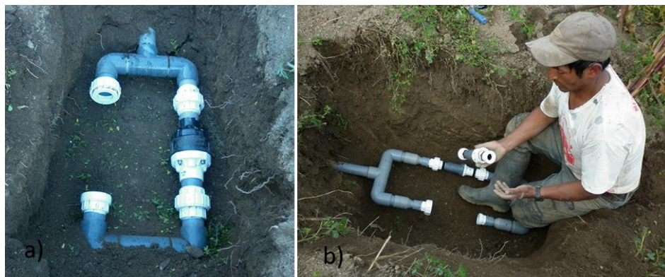
Figura 10: manteniinto de reguladores de presion en a) reguladores de presión PRXF – LV 3” de 40 PSI en tubería de 90 mm y b) reguladores de presión PRXF – LV 1” de 30 PSI en tubería de 1 ½”.
