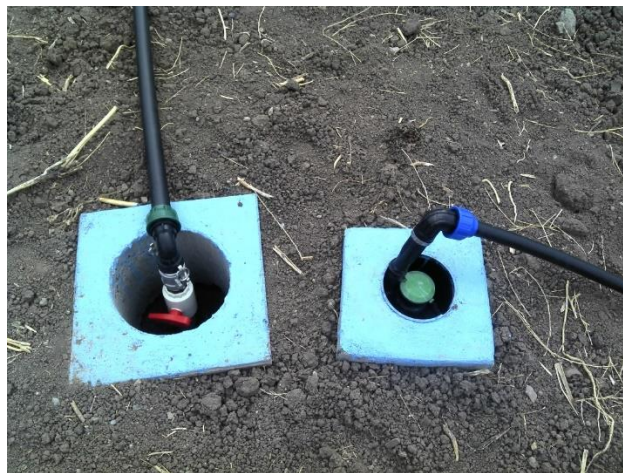
Figura 14: Toma de hidrantes
