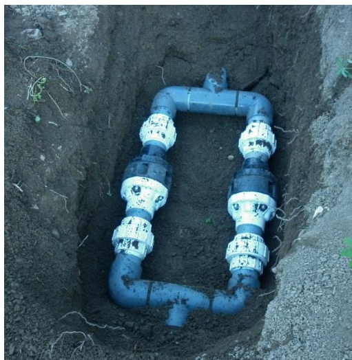
Figura 1.6: Reguladora de presión instalada en paralelo modelo PRXF – LV- 40 PSI (Senninger) en tubería de 90mm
