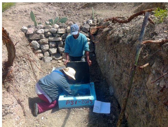
Figura 5: Operación de la válvula de descarga en el reservorio
