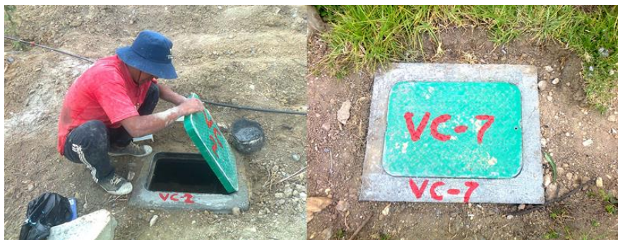
Figura 6: Cajas de válvula de control
