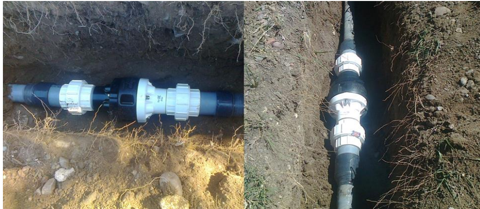
Figura 8: Reguladores de presión PRXF-LV de 30 PSI Senninger en la tubería de 63mm por el caudal que pasa se clasifica en tipo I
