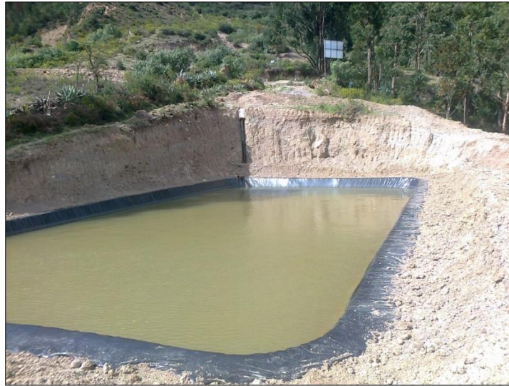
Figura 4: Reservorio de geomembrana de PVC de 1.0 mm
