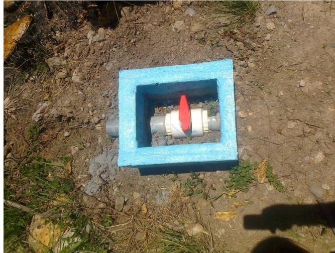
Figura 23: Válvula de purga
