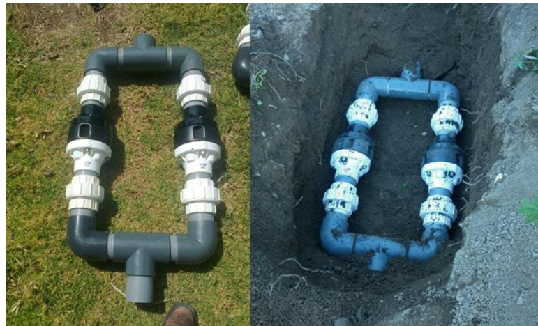
Figura 9: Reguladores de presión PRXF-LV de 30 PSI Senninger en tubería 90 mm por el caudal que pasa se clasifica en tipo II
