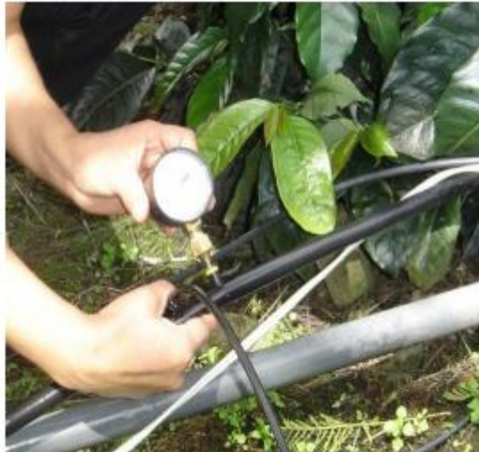
Figura 1.17: Medida de la presión del agua con manómetro en riego por goteo
