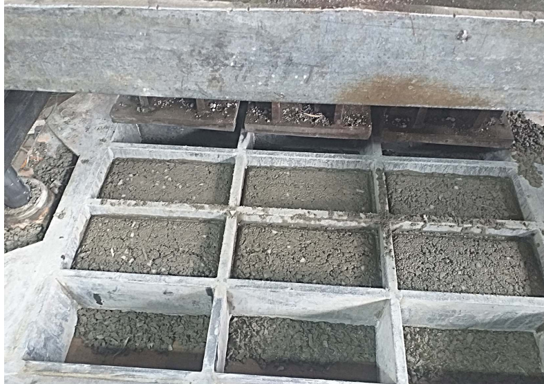
Figura 34 Visualización de la no segregación en el concreto después del vibrado y compactado
